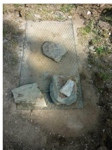
Figura 92 – Infraestrutura de proteção da captação com tampa metálica.
