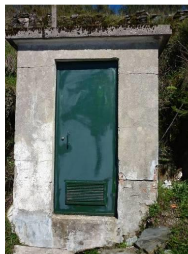
Figura 160 – Infraestrutura de proteção em betão com porta de metal com fechadura da captação.
