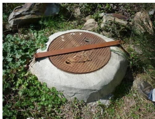
Figura 88 – Infraestrutura de proteção com tampa em ferro fundido da captação.
