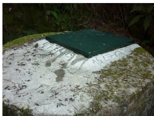
Figura 101 – Infraestrutura de proteção e acesso da mina.
