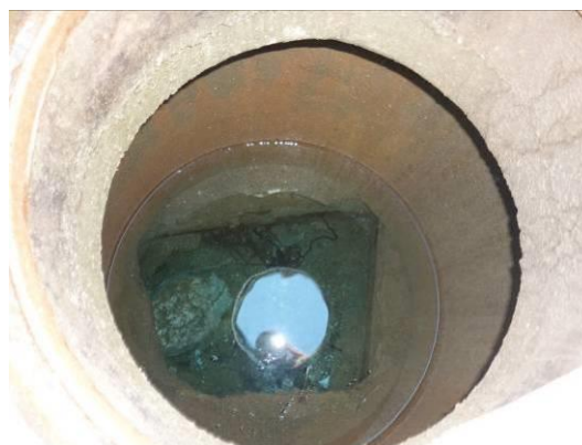
Figura 132 – Interior da infraestrutura de proteção e nascente em xisto.
