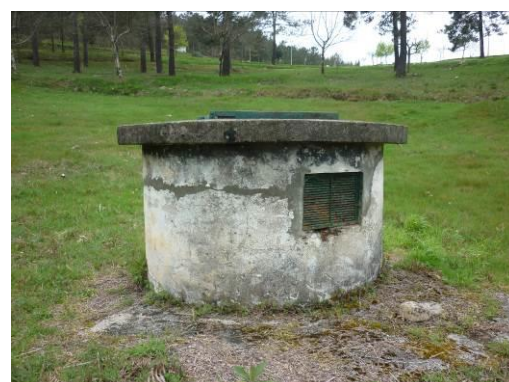
Figura 111 – Reservatório de água proveniente da caixa de junção de água da nascente 2.
