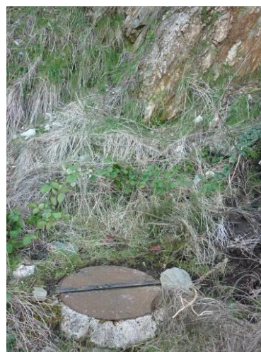
Figura 172 – Infraestrutura de proteção com tampa em ferro fundido da captação.
