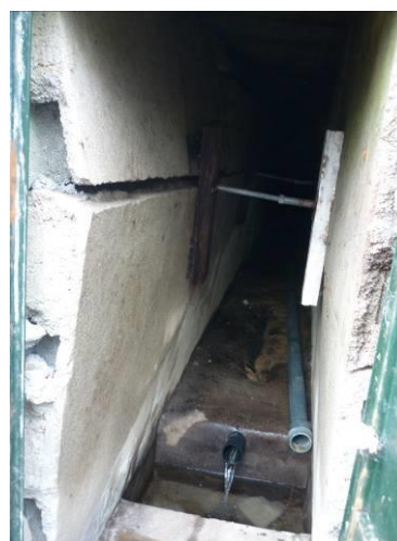
Figura 168 – Entrada para a galeria da mina com evidente desabamento.
