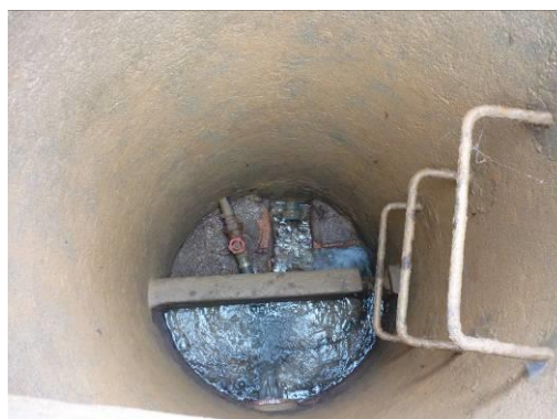
Figura 106 – Interior da caixa de junção de água de uma nascente 1.
