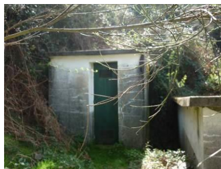
Figura 147 – Área envolvente da mina do Sistema de Abastecimento de Mourísia e infraestrutura de proteção com porta metálica.
