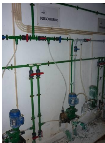
Figura 29 – Tubagens do doseador de coagulante e do leite de cal.
