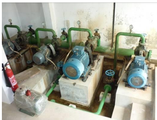
Figura 16 – Grupo de bombagem para as povoações de Urgueira e Maladão.
