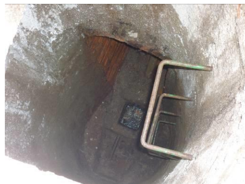
Figura 98 – Caixa de receção da água originária da mina.
