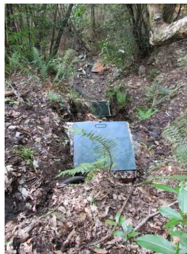
Figura 69 – Caixas de extração da água, da água proveniente da nascente separadas em 2m.
