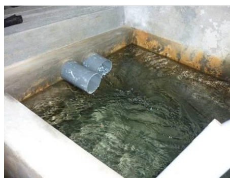
Figura 128 – Saída da água proveniente da mina por tubo em PVC para a caixa de receção da água.
