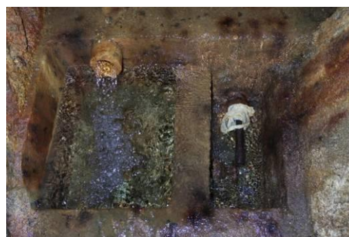
Figura 65 – Caixa de receção da água da captação.
