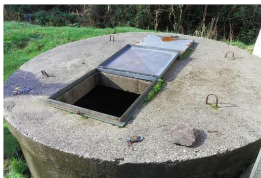
Figura 202 – Infraestrutura de proteção do poço com duas tampas de ferro.
