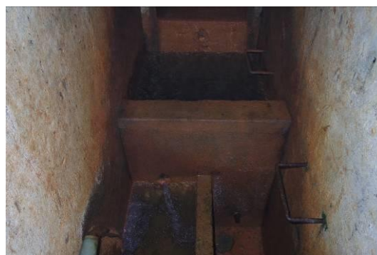
Figura 56 – Caixa de receção da água da captação.
