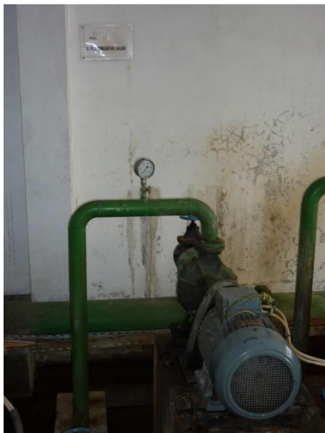
Figura 18 – Grupo de Bombagem para o Maladão.
