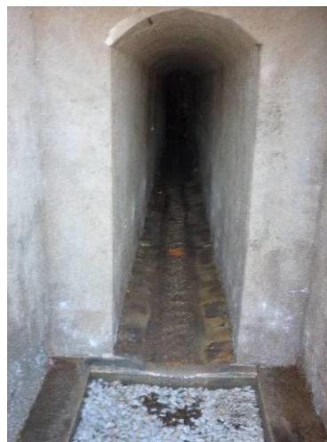
Figura 151 – Interior da infraestrutura de proteção da galeria da mina e caixa de receção da água com tratamento em brita.
