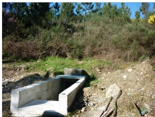
Figura 122 – Área envolvente da captação (Mina 1) do Sistema de Abastecimento de Dreia.
