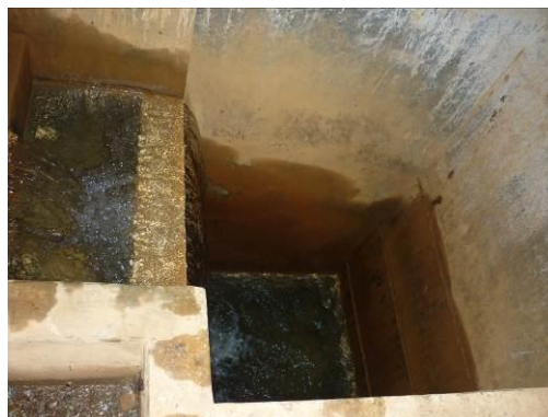
Figura 28 – Caixa de receção de água vinda da mina.
