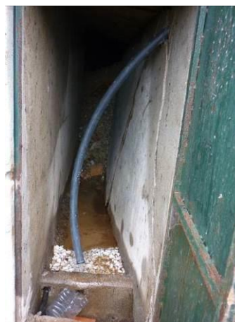
Figura 165 – Entrada da galeria da mina evidenciando a derrocada que sofreu e com tubo de água vindo da nascente.
