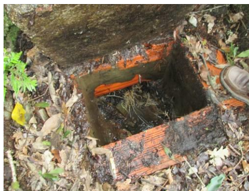
Figura 70 – Infraestrutura de proteção da nascente com tampa em betão.
