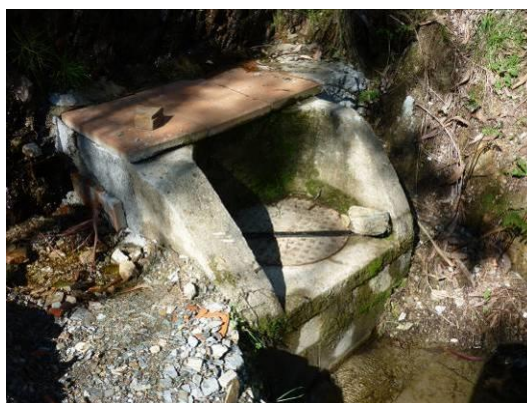
Figura 135 – Infraestrutura em betão com tampa em ferro fundido de proteção da captação.
