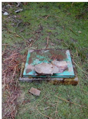
Figura 73 – Infraestrutura de proteção com tampa metálica fechada a cadeado da captação.
