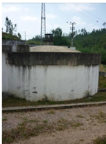
Figura 41 – Reservatório onde é armazenada a água tratada na ETA.
