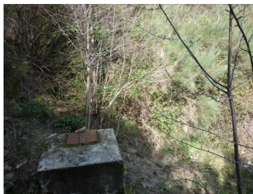
Figura 175 – Área envolvente da nascente do Sistema de Abastecimento de Soito da Ruiva.
