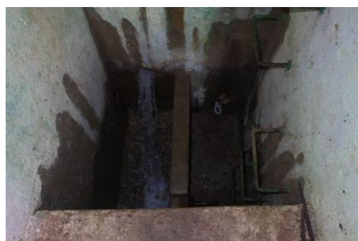
Figura 60 – Caixa de receção da água da captação.
