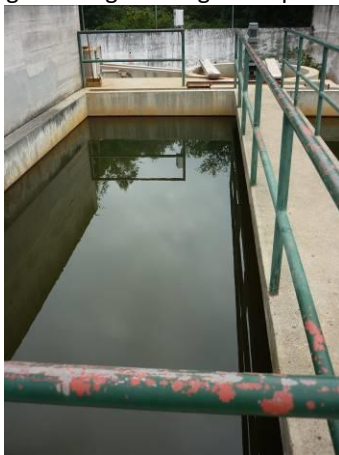
Figura 34 – Um dos tanques de decantação.
