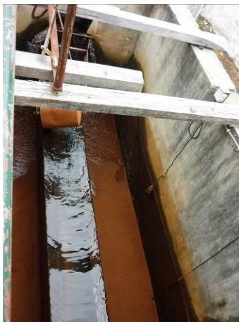
Figura 37 – Um dos tanques de filtração com areia.
