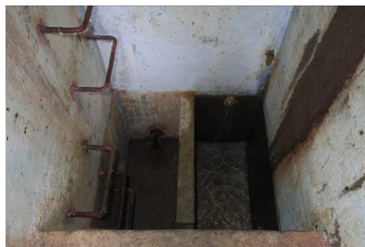
Figura 41 – Caixa de receção da água da captação.
