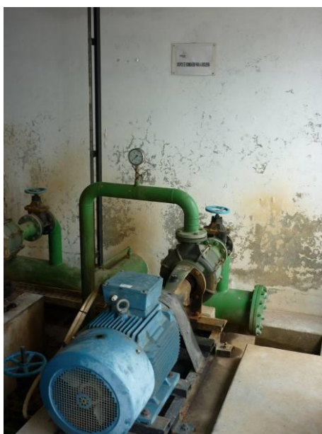
Figura 17 – Grupo de bombagem para a Urgueira.
