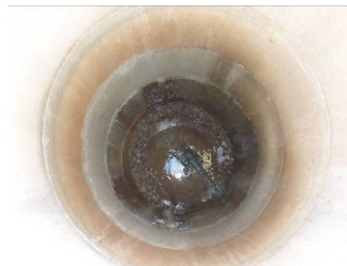
Figura 89 – Interior da infraestrutura de proteção e nascente.
