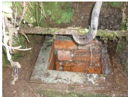
Figura 163-Caixa de receção de água da nascente.
