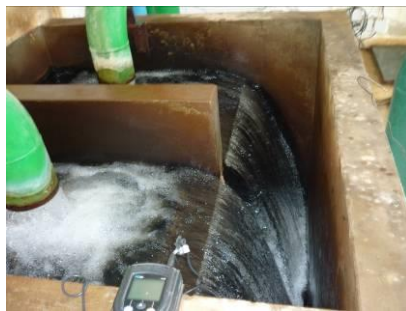
Figura 40 – Secção onde é feita a afinação de cloro final e queda de água para depois ser armazenada.
