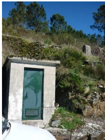
Figura 159 – Área envolvente da captação (Mina) do Sistema de Abastecimento de Relva Velha.
