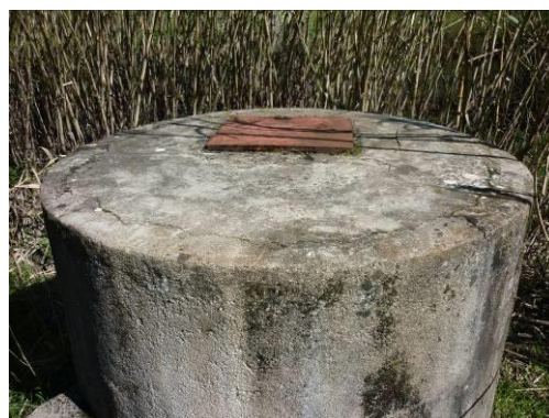
Figura 13 – Infraestrutura de proteção com tampa metálica fechada a cadeado da captação de água.
