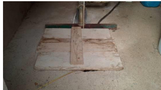
Figura 17 – Infraestrutura de proteção em betão e tampa de madeira do poço.
