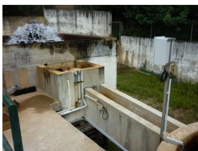
Figura 31 – Arejador, divisória com tubagem onde é feita a pré cloração, adicionado o leite de cal, o coagulante (cloro hidróxido sulfato de alumínio) e o floculante e respectiva passagem para o agitador.
