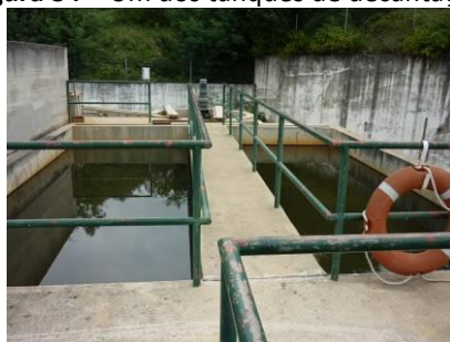
Figura 35 – Os dois decantadores da ETA.
