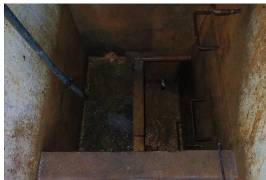
Figura 46 – Caixa de receção da água vinda da captação.
