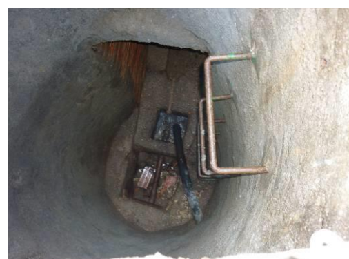
Figura 103 -Caixa de receção da água vinda da mina e da mina 1 localizada numa cota superior.
