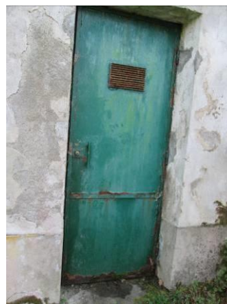
Figura 180 – Infraestrutura de proteção com porta metálica fechada a chave da captação.
