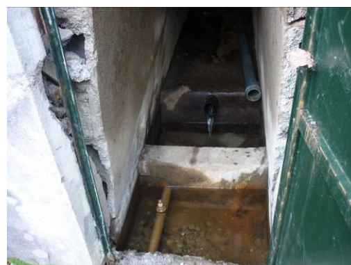
Figura 169 – Caixa de receção de água da mina.
