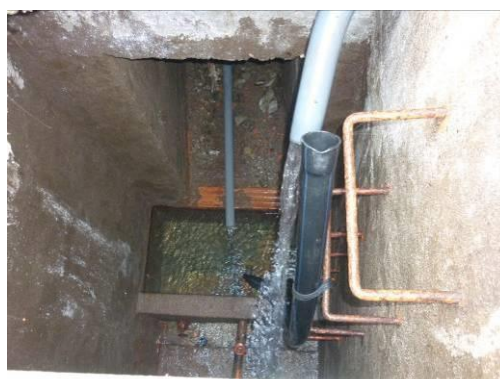
Figura 177 – Caixa de receção de água dos tubos vindos da nascente localizados nas rochas.
