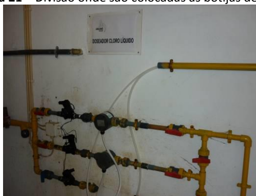
Figura 22 – Tubagens do doseador de cloro.
