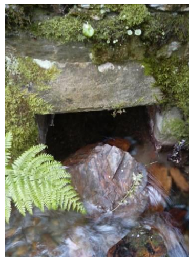
Figura 114 – Estrutura da nascente onde é captada a água para o poço situado do lado direito.
