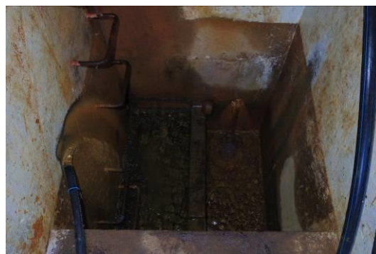
Figura 51 – Caixa de receção da água vinda da captação.
