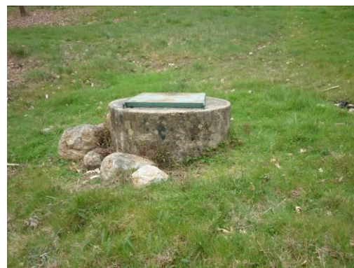
Figura 107 – Infraestrutura de proteção da caixa de junção de água.
