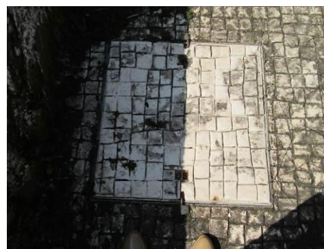
Figura 198 – Tampa do poço fechada a cadeados para impedir o acesso ao seu interior.
