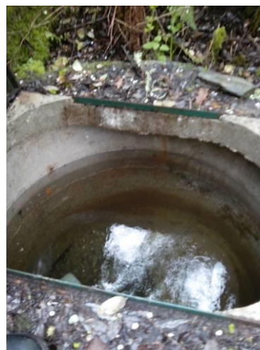
Figura 115 – Poço onde a água se concentra vinda da nascente.
