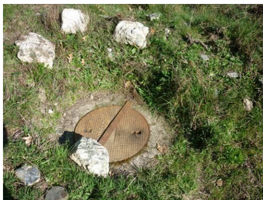
Figura 131 – Infraestrutura de proteção da nascente em betão com tampa em ferro fundido.
