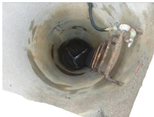
Figura 110 – Interior da caixa de junção de água da nascente 2 e da água vinda da caixa da nascente 1, neste momento desativada.
