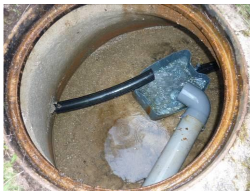
Figura 173 – Caixa de receção de água dos tubos vindos da nascente localizados nas rochas.
