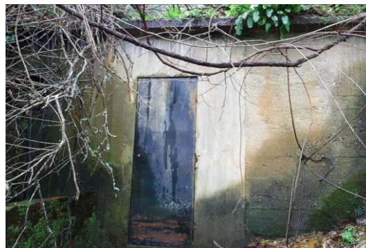
Figura 210 – Infraestrutura de proteção para a Mina com porta metálica.
