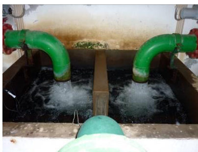
Figura 39 – Divosória onde è descarregada a água vinda dos tanques com filtros de areia.
