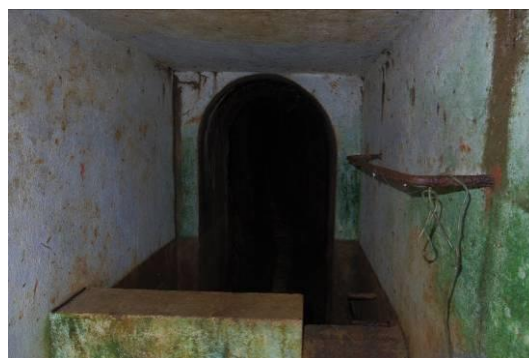
Figura 45 – Interior da Infraestrutura de proteção e entrada para a galeria da mina 2.
