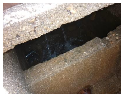
Figura 77 – Caixa de receção de água vinda da Nascente 1, Mina 1, Nascente 2, Nascente 3 e do reservatório.
