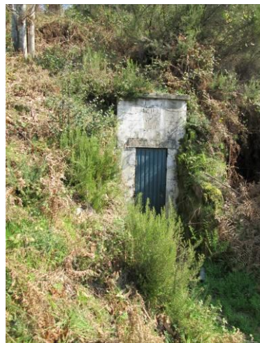
Figura 184 – Área envolvente da mina e infraestrutura de proteção com porta fechada a chave do Sistema de Abastecimento de Travessas.
