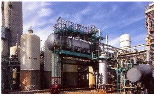
Figura 3.9 – Purificação de Hidrogénio.
