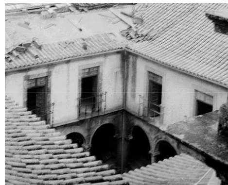
Figura 98 – Estado de ruína do Convento
