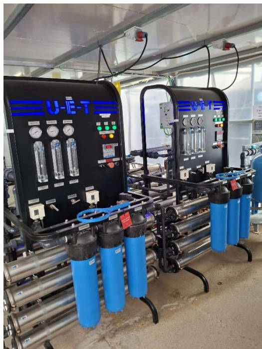
Figura – Sistema de filtragem de água, Osmose Inversa, da estufa da MHI e sala de rega (Fonte: MHI S.A.)
