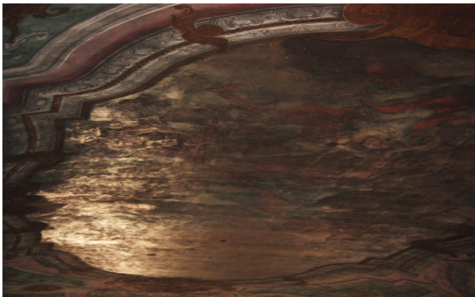
Figura 70. Camada de proteção envelhecida e oxidada.
