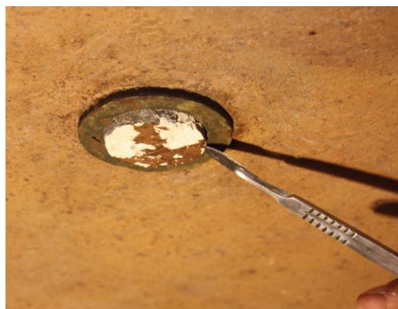
Figura 64. Preenchimentos volumétricos provenientes de antigas intervenções considerados inadequados e envelhecidos.
