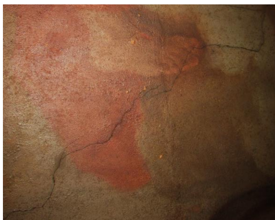
Figura 63. Fissuras na superfície pictórica que acabam por alcançar e abranger o suporte arquitetónico.
