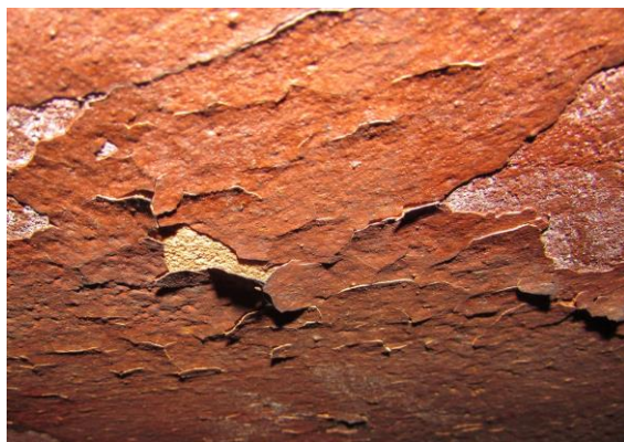
Figura 66. Camada cromática em descolamento e em risco de perda iminente.
