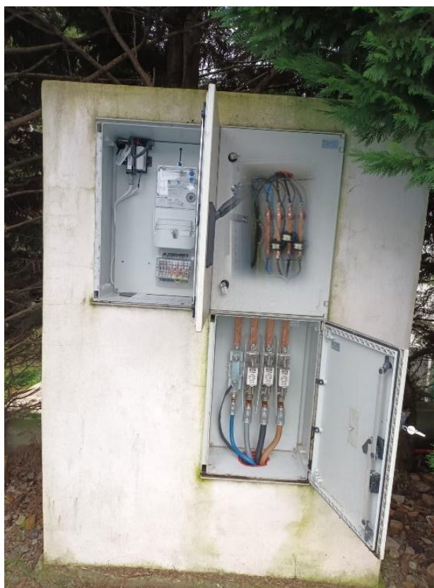
Figura 4.3-7- Murete para BTE com as 3 caixas
