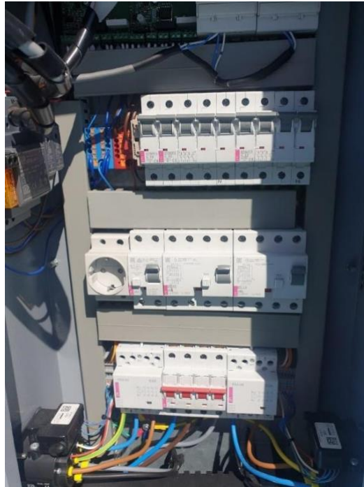
Figura 4.3-5 – Vista da lateral Esquerda do Carregador
