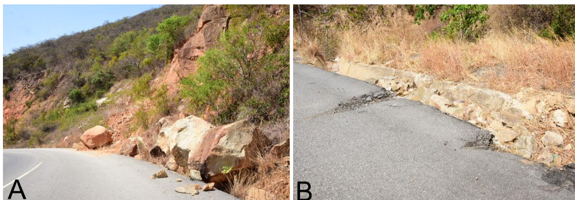
Figura 3.8- Serra da Leba: a) Deslizamento de materiais; b) Deformação da encosta que afeta o pavimento
