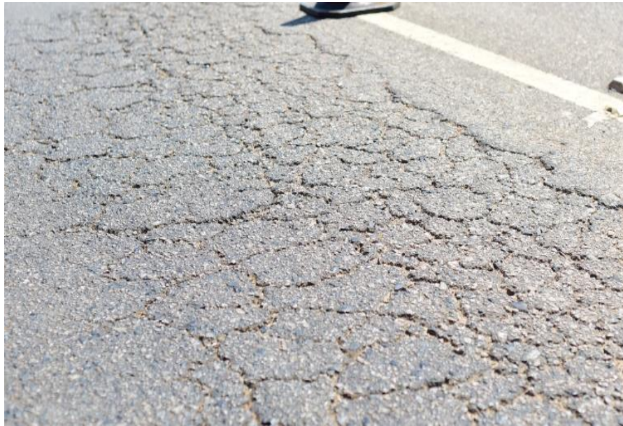
Figura 2.8 Raveling - Desgaste da superfície – Serra da Leba
