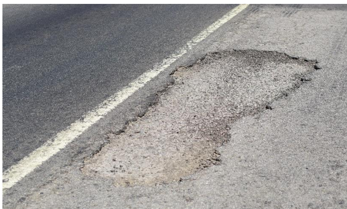
Figura 3.7- Desagregação da camada de desgaste (Pelada) – serra da Leba
