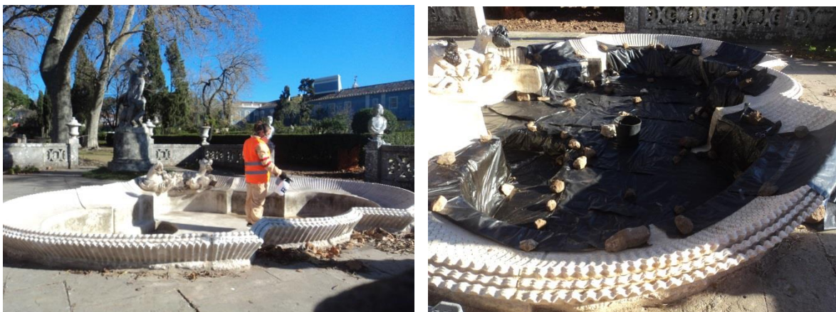
Figura 21 – Segunda aplicação de biocida, por pulverização e cobertura de proteção para potenciar a ação do produto, através da saturação do ambiente.
