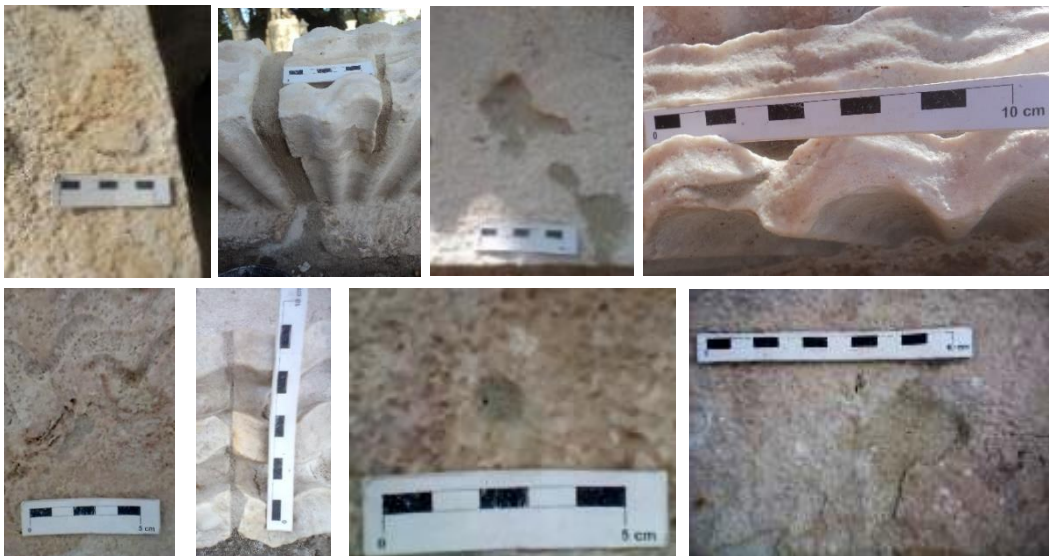
Figura 36 – Áreas onde se realizou micro estucagem pontual para impedir a acumulação de sujidade
