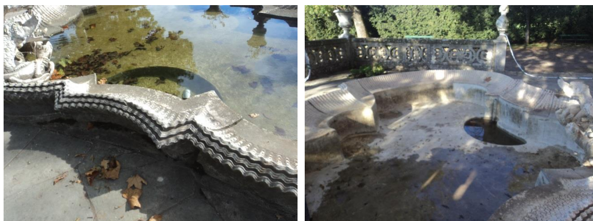
Figura 17 – Vazamento do tanque
