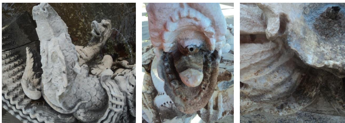
Figura 25- Áreas de sujidade mais agregada.
