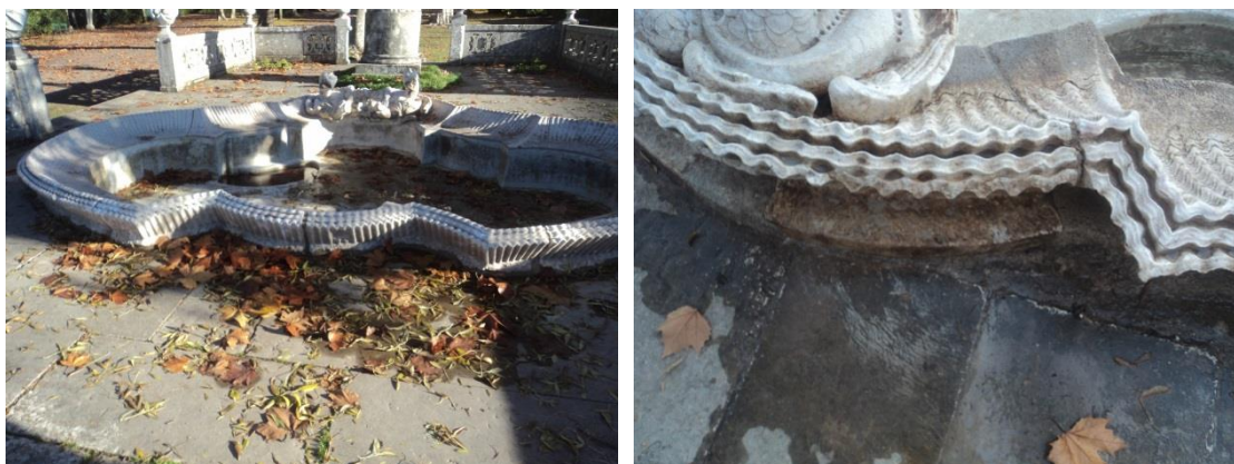
Figura 24 – Áreas de acumulação de água e detritos.
