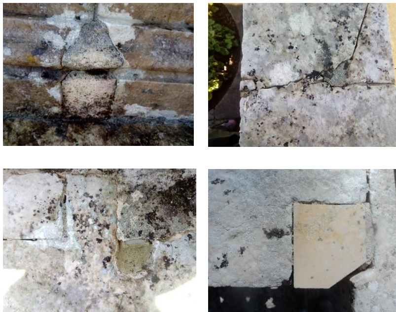
Figura 41 – Intervenções anteriores na balaustrada
