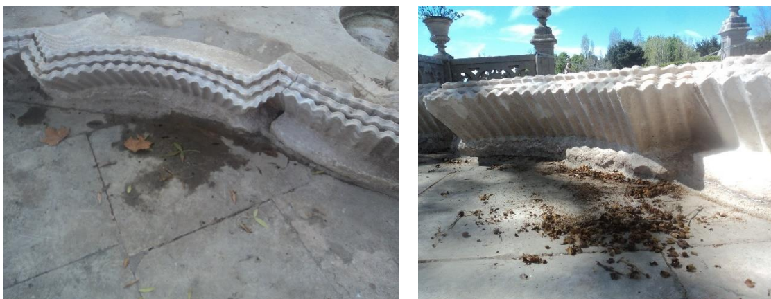
Figura 12 – área de desnivelamento do pavimento que aglomera detritos e água junto à obra
