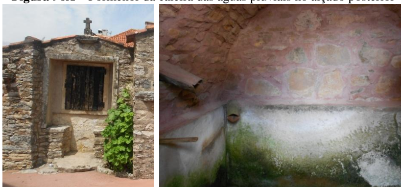
Figura 97A – Cisterna no pátio com sistema de encaminhamento para aproveitamento das águas pluviais
