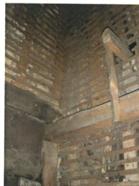
Parede de tabique sem reboco
