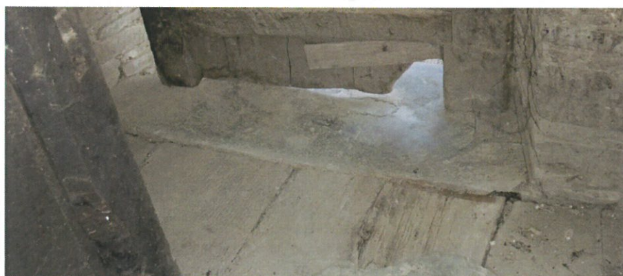
Fig.41 Pormenor de encontro entre tabuado "sobrado" com a pedra de soleira (Inq.05).
