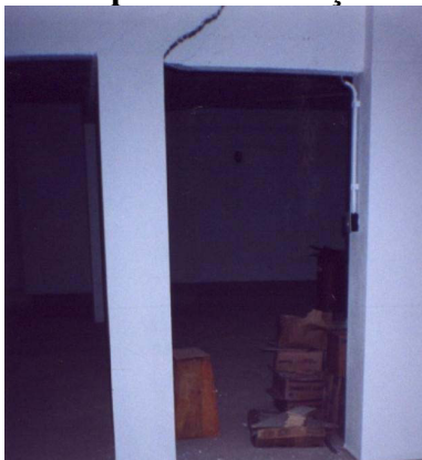
Figura 43: Fissuração na estrutura viga 1
