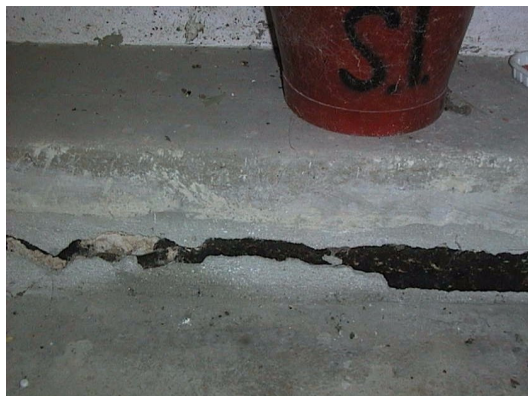
Figura 8: Assentamento de pavimento.
