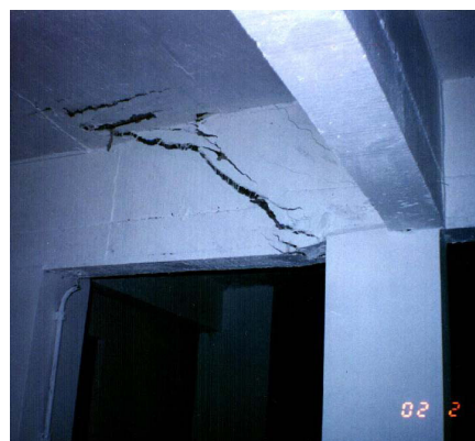
Figura 11: Fissuração na estrutura viga.
