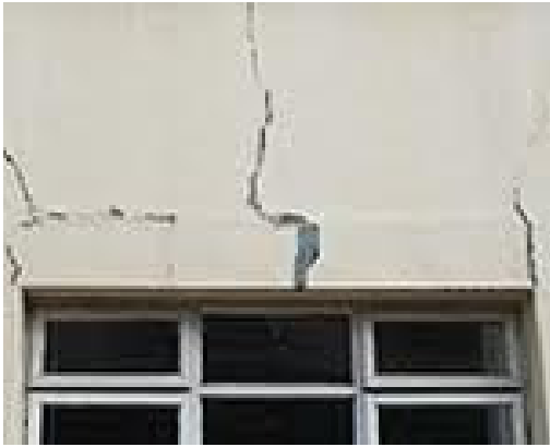
Figura 47: Fissuração Fachadas vãos 5
