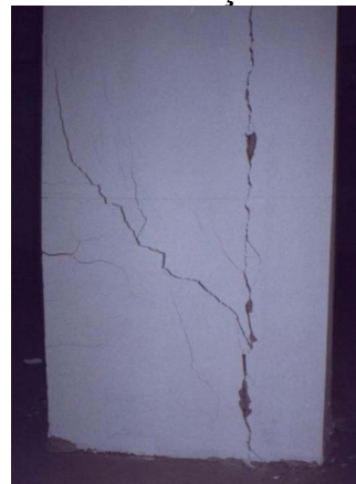
Figura 44: Fissuração na estrutura Pilar 2
