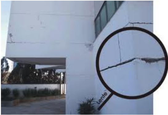
Figura 45: Fissuração em Fachadas 3
