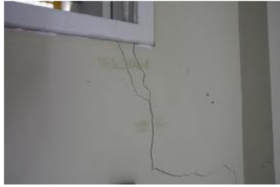
Figura 46: Fissuração Fachadas vãos 4
