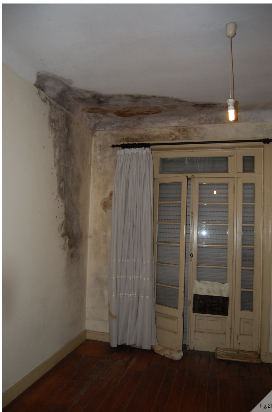
Fig. 16 E 17_ Pátio e Fachada Traseira Fig. 18, 19, 20 e 21_ Fotos do interior, que demonstram os problemas existentes em termos de humidades e caixilharias.
