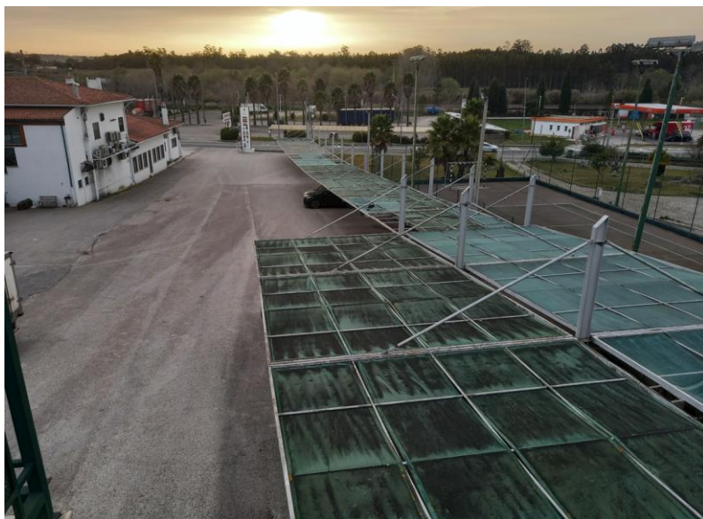
Figura 6.85 - Local antes da implementação do sistema fotovoltaico
