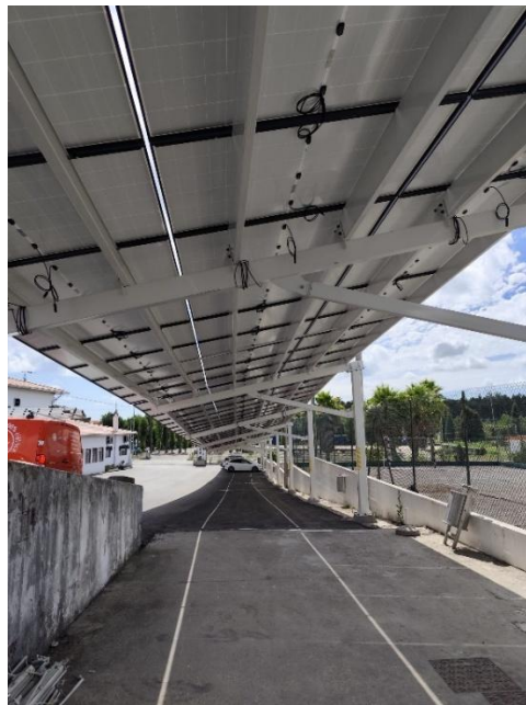
Figura 6.88 – Implementação real da instalação fotovoltaica
