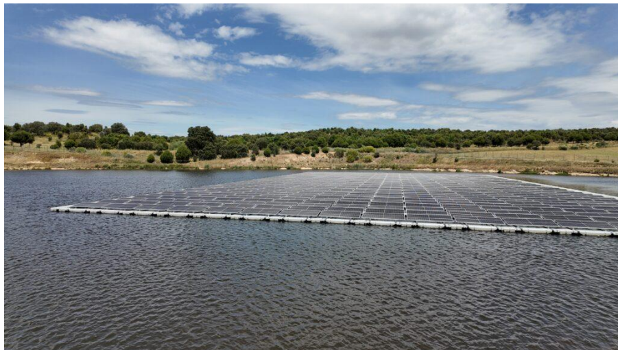
Figura 6.56 – Implementação real da instalação fotovoltaica
