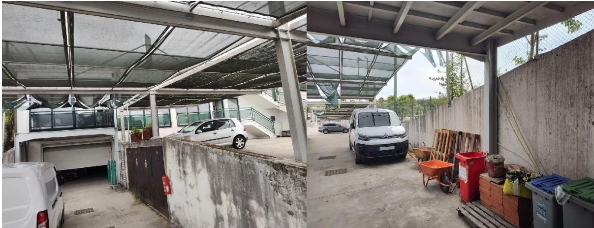
Figura 6.84 - Local antes da implementação do sistema fotovoltaico
