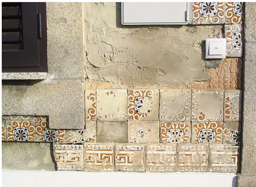
Lacunas de azulejos, algumas preenchidas com cimento
