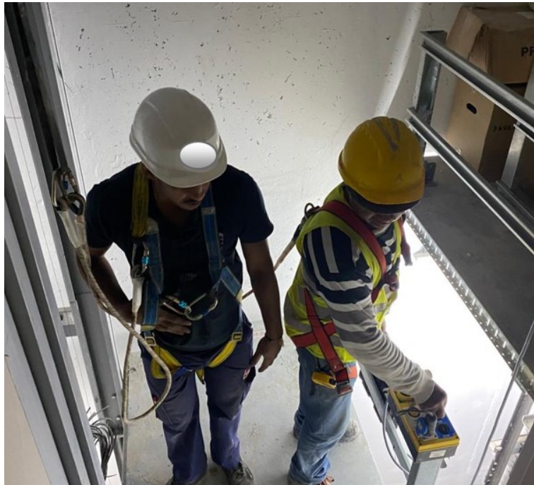
Figura 5 Imagem da caixa elétrica da cabina do elevador
