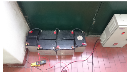
(f) Conjunto das baterias à carga, fora do veículo. Note-se o carregador dedicado, à direita.
