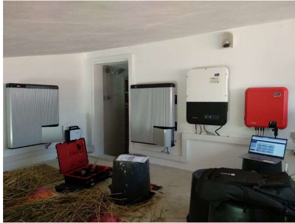
Figura 27 - Acoplamento AC com Inversor de Rede SMA (vermelho) e Inversor de Bateria SMA (branco e preto)
