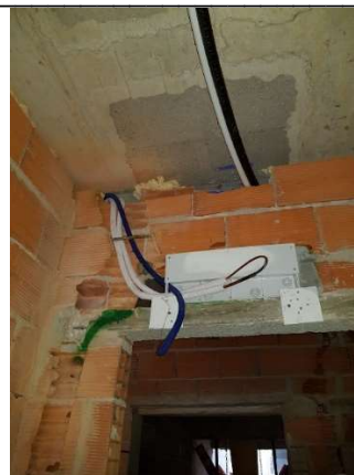
Figura 37 - Pré-instalação de Ar Condicionado (interior)
