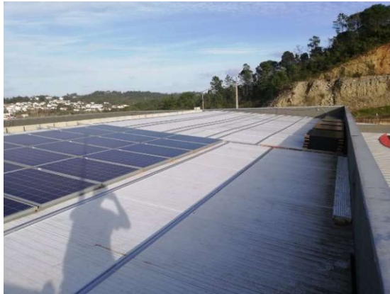
Figura 38 - Ampliação a FV existente (antes)
