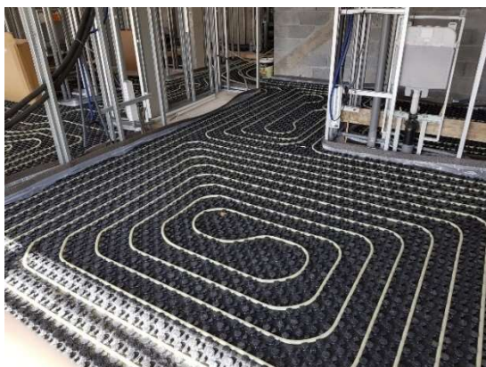
Figura 34 - Piso Radiante Daikin
