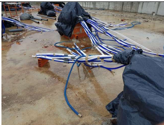
Figura 36 - Pré-instalação de Ar Condicionado (exterior)
