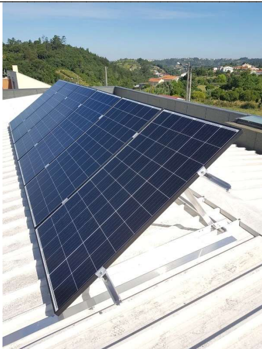
Figura 40 - Instalação FV em telhado chapa sanduiche com inclinação dada pela estrutura
