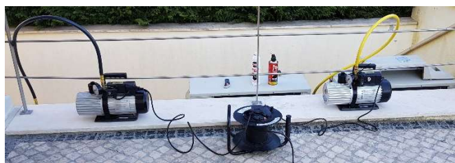
Figura 43 - Processo de vácuo numa instalação de Ar Condicionado
