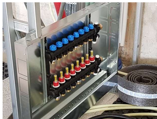
Figura 35 - Coletores hidráulicos para Piso Radiante Daikin
