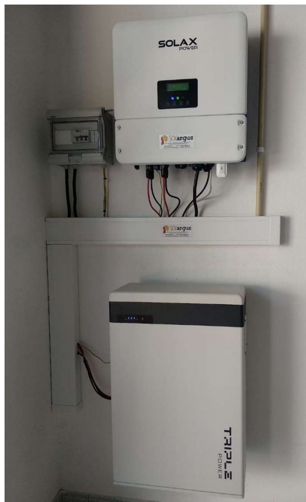
Figura 26 - Acoplamento DC com Inversor híbrido Solax e Bateria de Lítio
