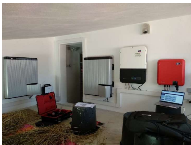
Figura 44 - Substituição do Inversor de Bateria SMA Sunny Boy Storage (branco e preto)
