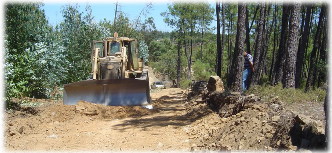
Figura 29 - Abertura da circular de Proteção
