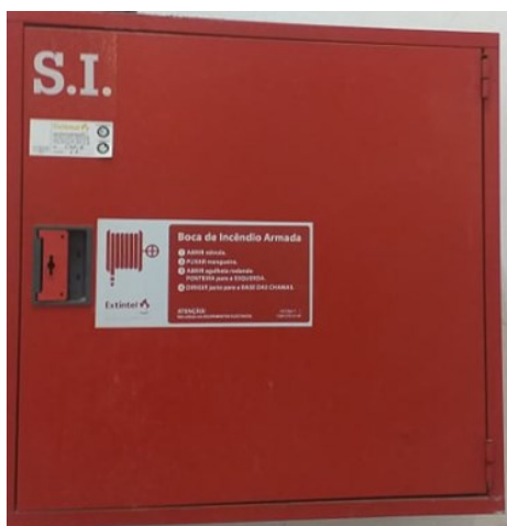
Figura 23 - Boca armada de incêndio
