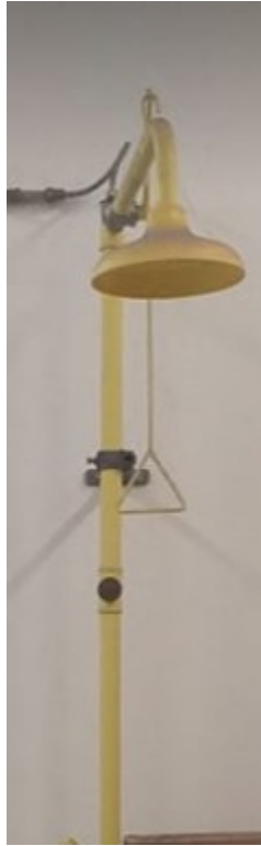
Figura 21- Chuveiro de emergência
