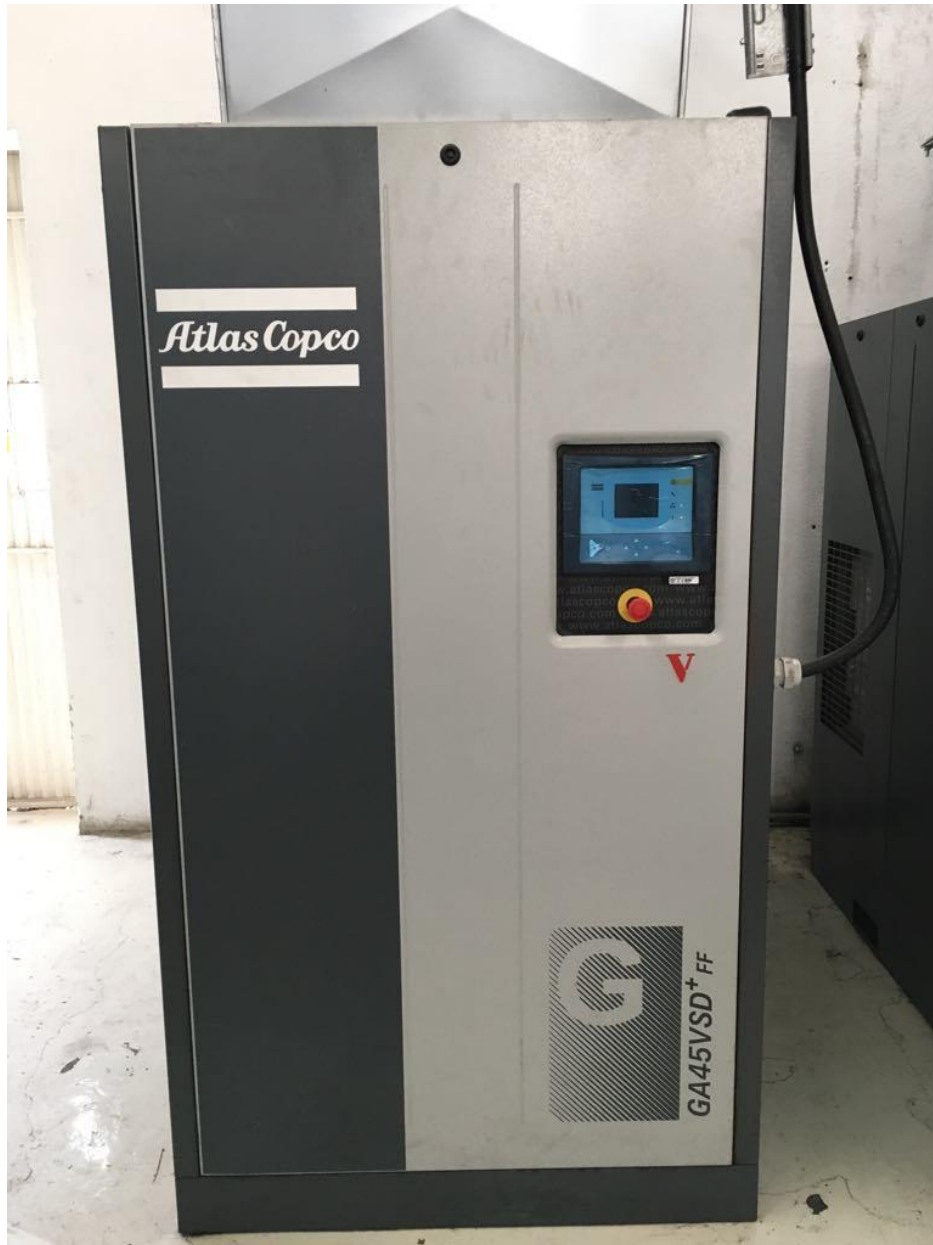
Figura 56 - Compressor Atlas Copco GA45VSD.
