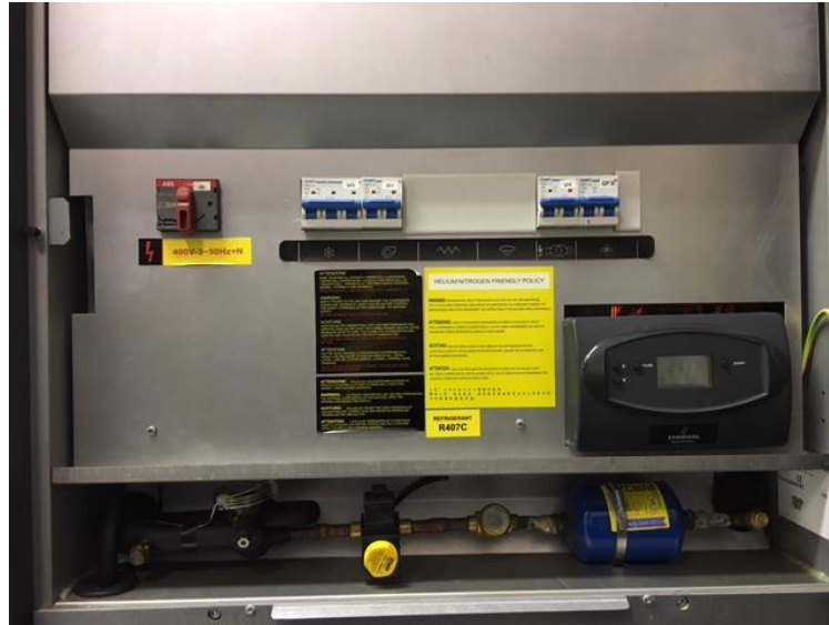
Figura 41 - Quadro de comando do AC dos datacenters . [8]
