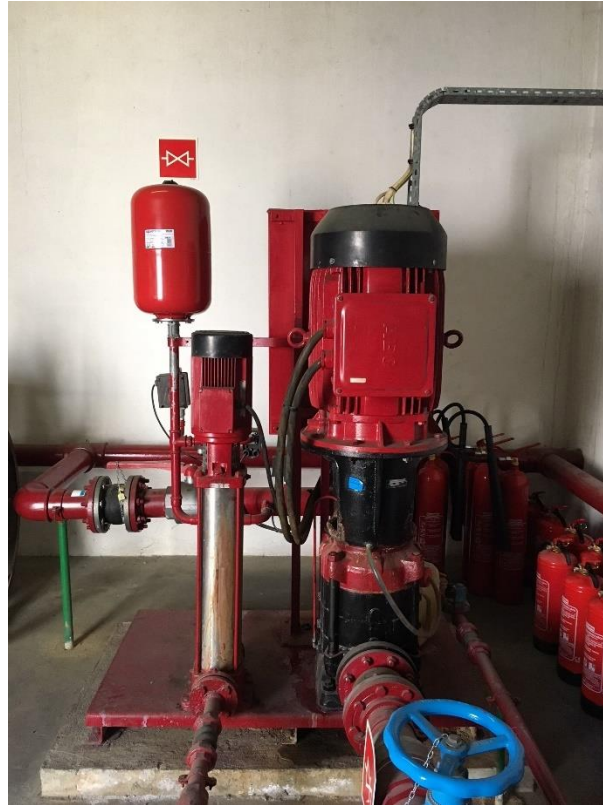
Figura 43 - Rede de Incendio Armada.
