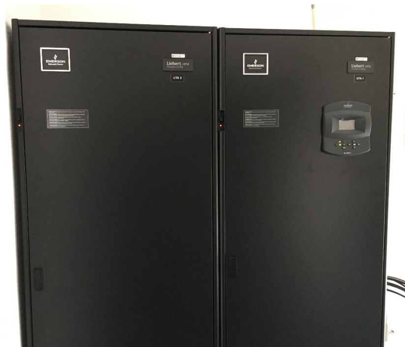
Figura 40 - Unidade de arrefecimento dos datacenters . [8]
