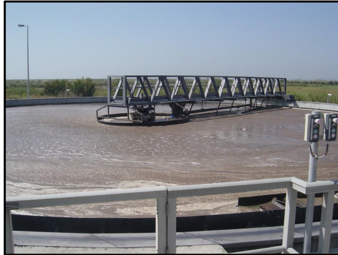
Figura 20 - Decantador Secundário da ETAR de Alverca (S. I. S. Mendes, 2014)
