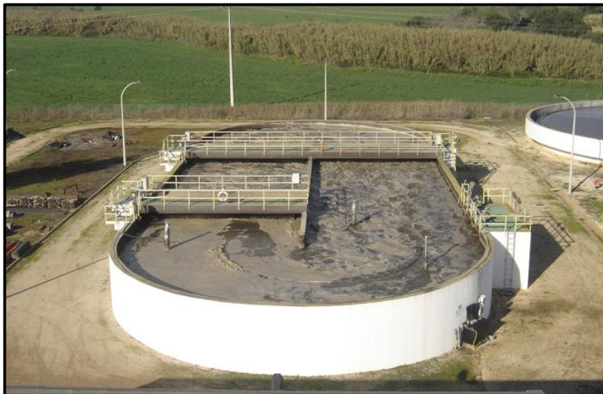
Figura 21 - Reservatório de lamas na ETAR de Lagos. Fonte: www.aguasdoalgarve.pt
