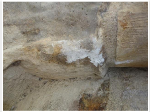
Figura A 106: Eflorescências, claustro, inspeção periódica. 10-05-13
