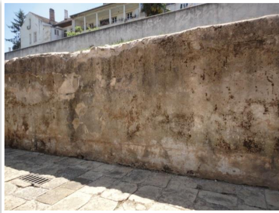
Figura A 107: Aspecto dos muros de limitação, com colonização biológica em estado latente, claustro, inspeção periódica. 10-05-13
