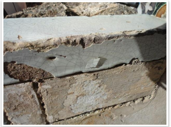
Figura A 110: Deterioração do azulejo, claustro, inspeção periódica. 10-05-13
