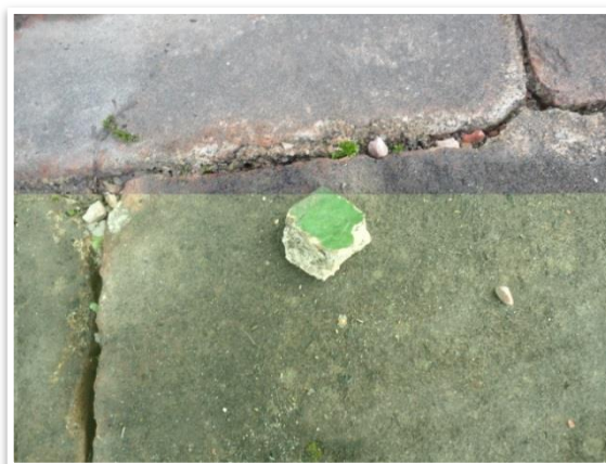
Figura A 88: Registo fotográfico de fractura vista durante as inspeções periódicas, claustro. 5-12-13
