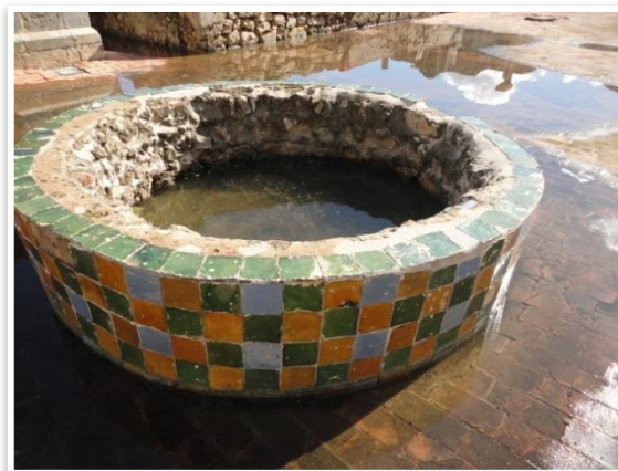
Figura A 81; Empoçamentos, Claustro, inspeção periódica. 30-10-13
