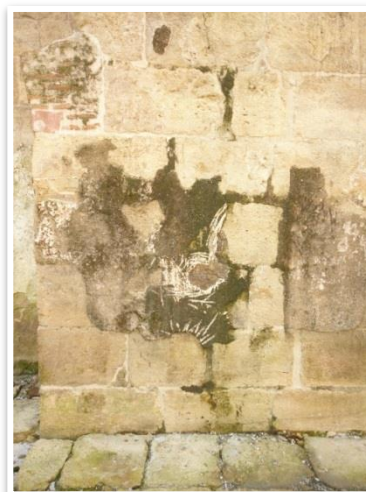
Figura A 104: Vandalismo, exterior, Igreja, inspeção periódica. 7-04-13
