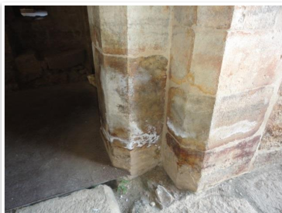
Figura A 111: Eflorescências, exterior, igreja, inspeção periódica. 10-05-13
