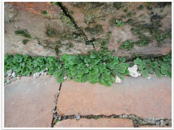
Figura A 94: Colonização biológica, algas, claustro, inspeção periódica. 8-01-13
