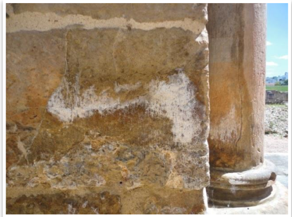
Figura A 108: Eflorescências, claustro, inspeção periódica. 10-05-13
