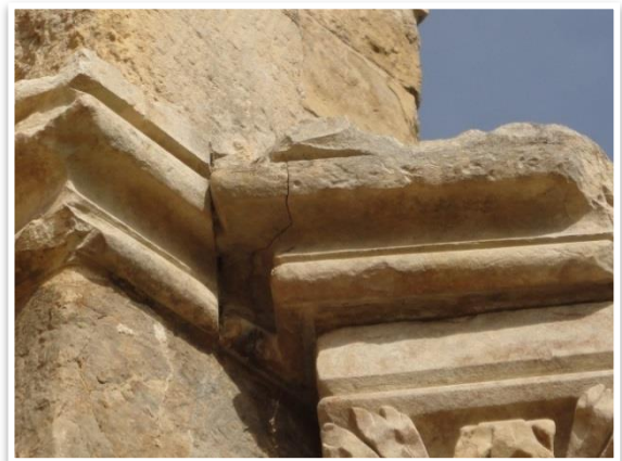
Figura A 98: Fractura, capitel, claustro, inspeção periódica. 15-02-13
