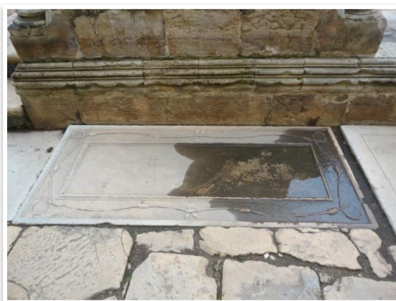
Figura A 87: Empoçamento, com terras acumuladas, pavimento, 5-12-13
