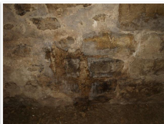
Figura A 103: escorrências de água contaminada pelo lado exterior, interior, Igreja, inspeção periódica. 6-03-13
