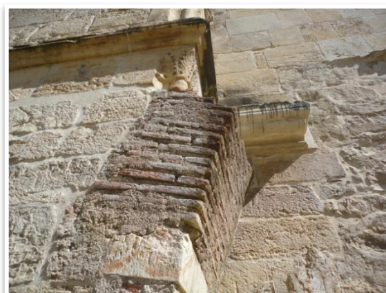
Figura A 114: Escorrências negras, exterior, igreja, inspeção periódica. 10-05-13
