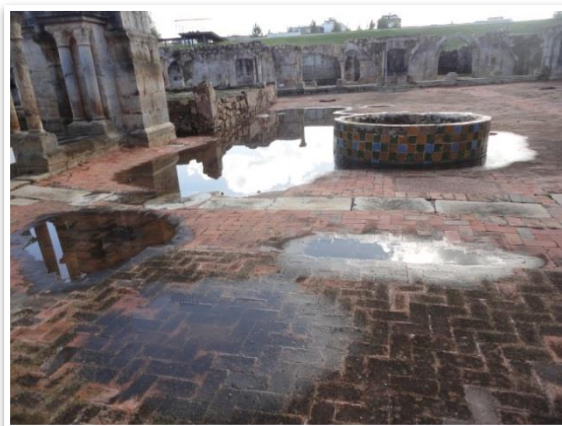
Figura A 80: Empoçamentos, Claustro, inspeção periódica. 30-10-13
