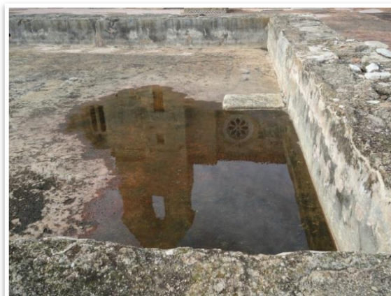
Figura A 77: Empoçamento, Claustro, inspeção periódica. 23-10-13
