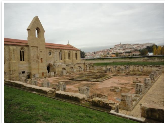
Figura A 86: Aspecto do claustro, inspeção periódica. 5-12-13
