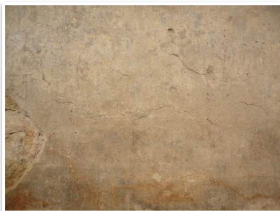
Figura A 101: Fissuras sobre rebocos, exterior, Igreja, inspeção periódica. 6-02-13
