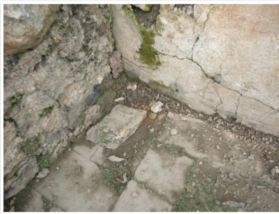
Figura A 95: Destacamento de fragmentos do reboco dos muros dos canteiros, claustro, inspeção periódica. 6-02-13
