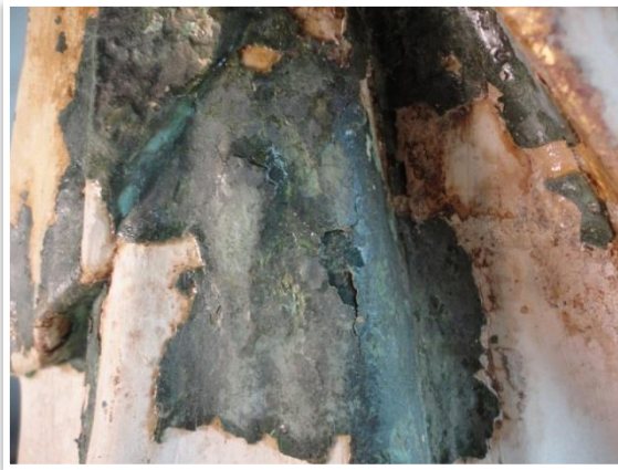
Figura A 46: Policromia em risco de descolamento, Santiago.
