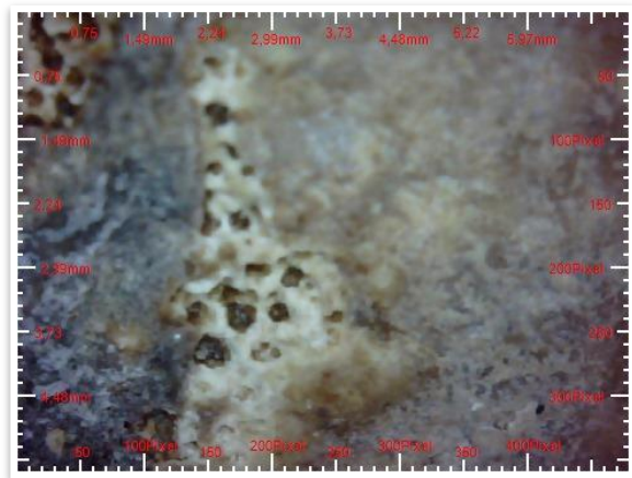
Figura 19: Pitting , processo acelerado pela utilização de AB57, processo já iniciado anteriormente, visto apenas após a limpeza das lamas sobre a superfície.
