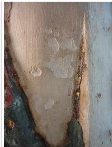
Figura A 51: Fractura da superfície devido à deterioração provocada por sais, Santiago.
