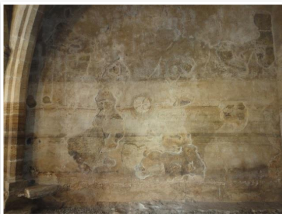
Figura A 85: Aspecto de parede interior, Igreja, inspeção periódica. 6-11-13
