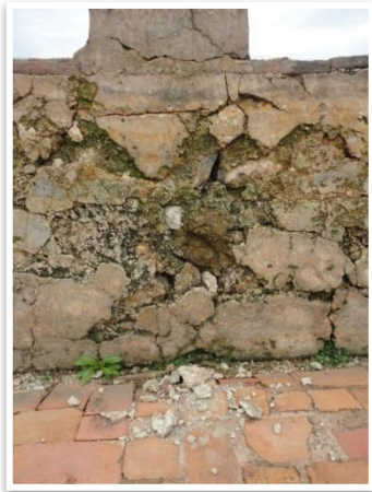
Figura A 93: Destacamento de fragmentos do reboco dos muros dos canteiros, claustro, inspeção periódica. 8-01-13
