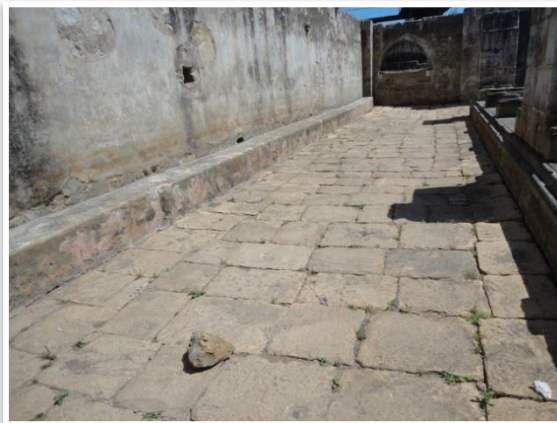
Figura A 109: Fragmento de grandes dimensões proveniente dos muros do claustro, inspeção periódica. 10-05-13
