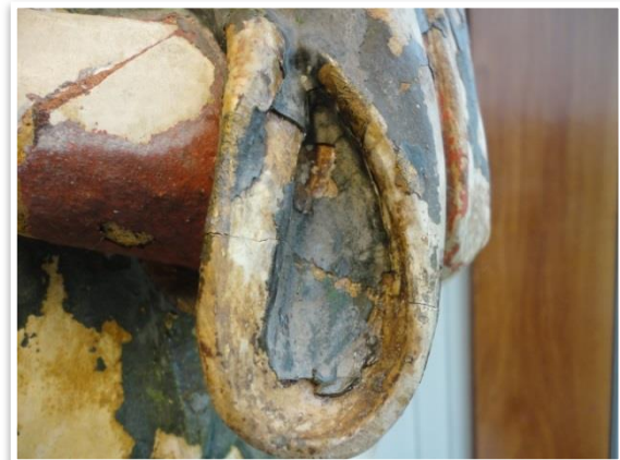
Figura A 45: Depósito de sujidade sobre a superfície, pormenor, Santiago.
