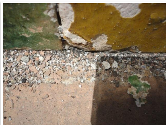
Figura A 115: Deterioração do azulejo, clasutro, inspeção periódica.09-06-13
