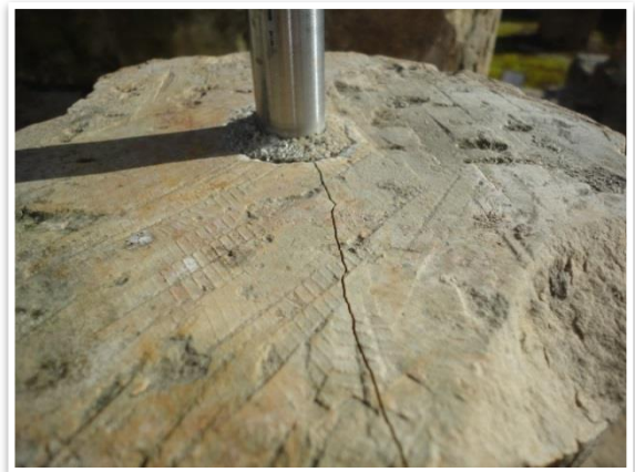
Figura A 96: Fractura de coluna devido a espigão, claustro, inspeção periódica. 6-02-13
