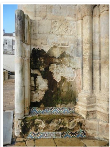
Figura A 89: Aspecto de parede exterior com colonização biológica, alçado sul, Igreja, inspeção periódica. 13-12-13
