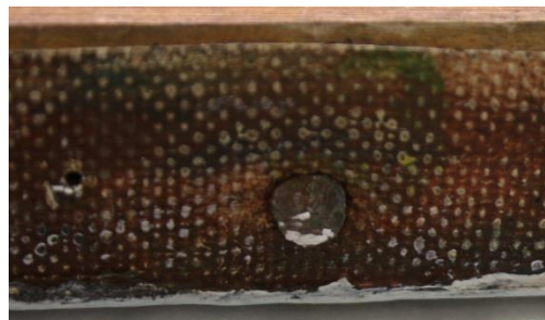
Figura 64 – Oxidação dos pregos da banda de pregaria.
