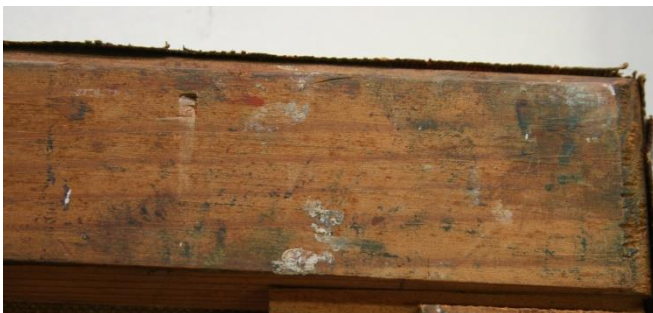
Figura 69 – Sujidade e manchas de tinta na grade da pintura.
