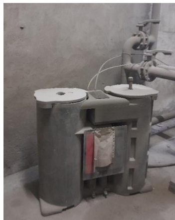
Figura 3.6 - Separador de Condensados Água/Óleo
