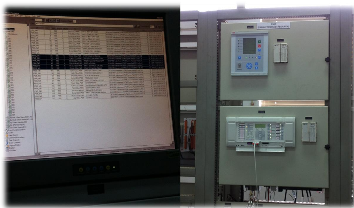
Figura 3.18- Ensaios na Subestação do Alto de S. João
