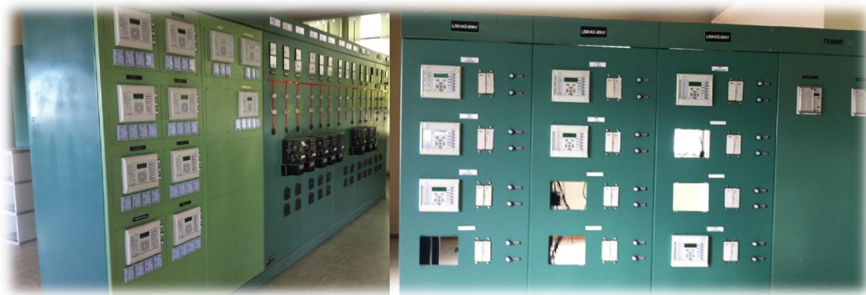
Figura 3.12-Visita à antiga Subestação de Seia. Na parte direita da imagem encontram-se IEDs MiCOM P435 a transferir para a nova Subestação e os espaços vazios dos já transferidos
