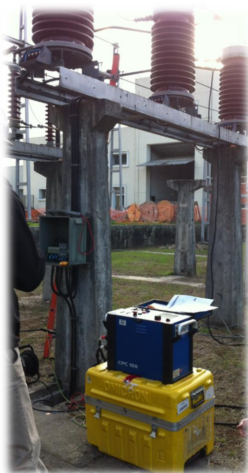
Figura 3.11- Ensaios primários realizados nos TI com equipamento primário CPC 100 da OMICRON
