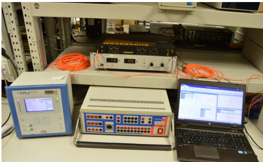
Figura 6.11- Bancada de testes utilizada nos testes e verificações realizadas em IEDs EFACEC
