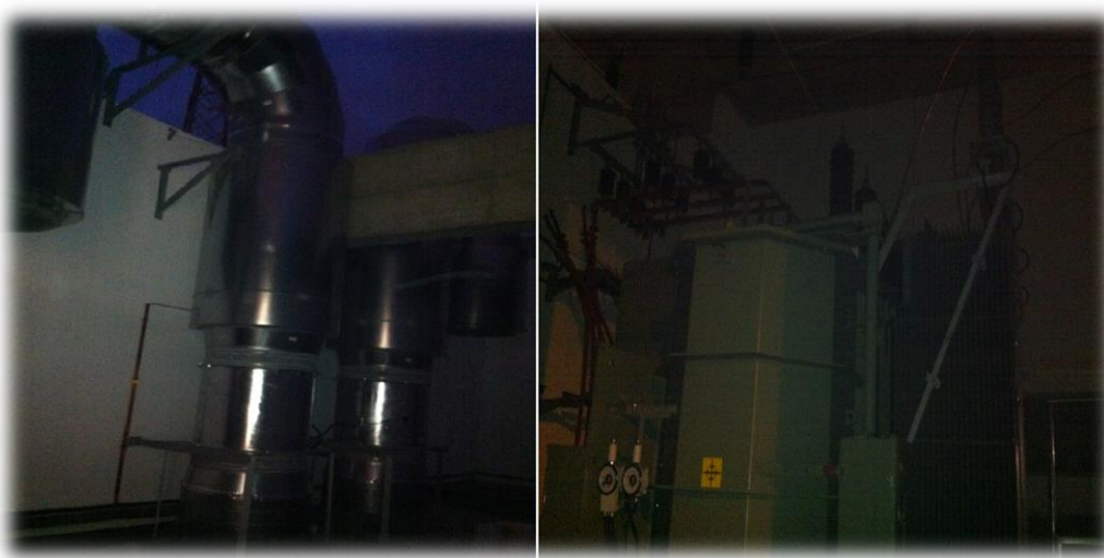
Figura 3.17- TP da Subestação de Barcarena e respetivas condutas de ar forçado
