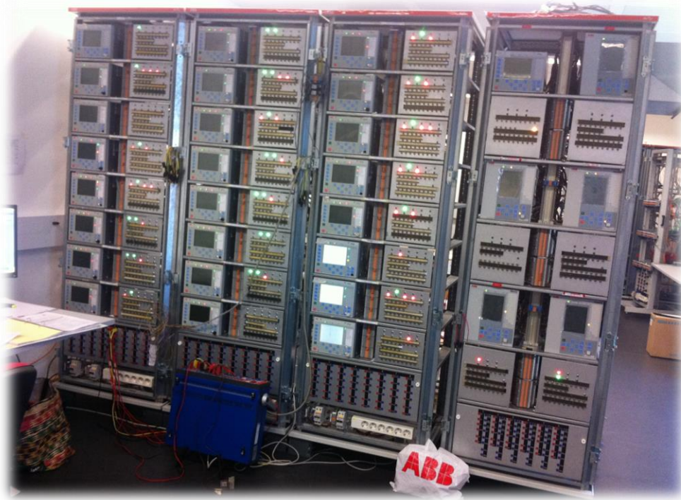
Figura 3.16- Ensaios de fábrica da Subestação de Coruche realizados na ABB
