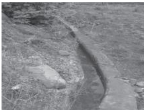
Figura 19: Canal de água Fonte: Ferreira et al. (2013)
