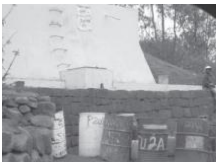
Figura 21: Cisterna para armazenamento da água Fonte: ferreira et al. (2013)
