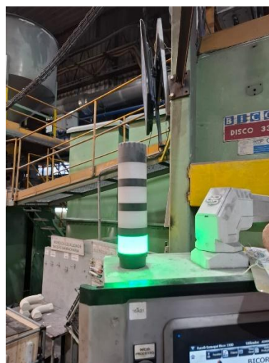
Figura 3.3 - Sinalização visual de avaria
