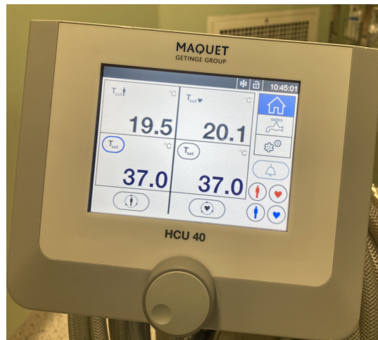
Figura 3.24: Computador de Controlo do Permutador de Calor.
