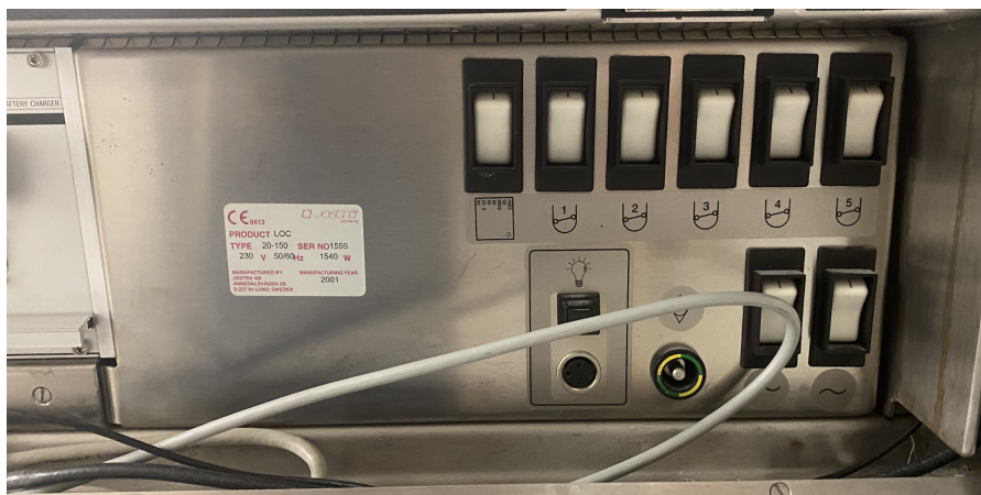
Figura 3.15: Interruptores de Controlo das Bombas.
