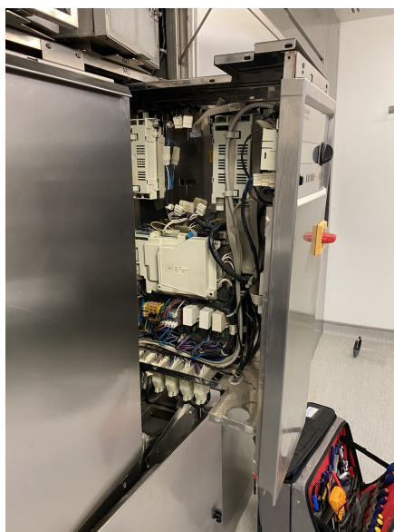
Figura 4.6: Área Elétrica da Máquina.
