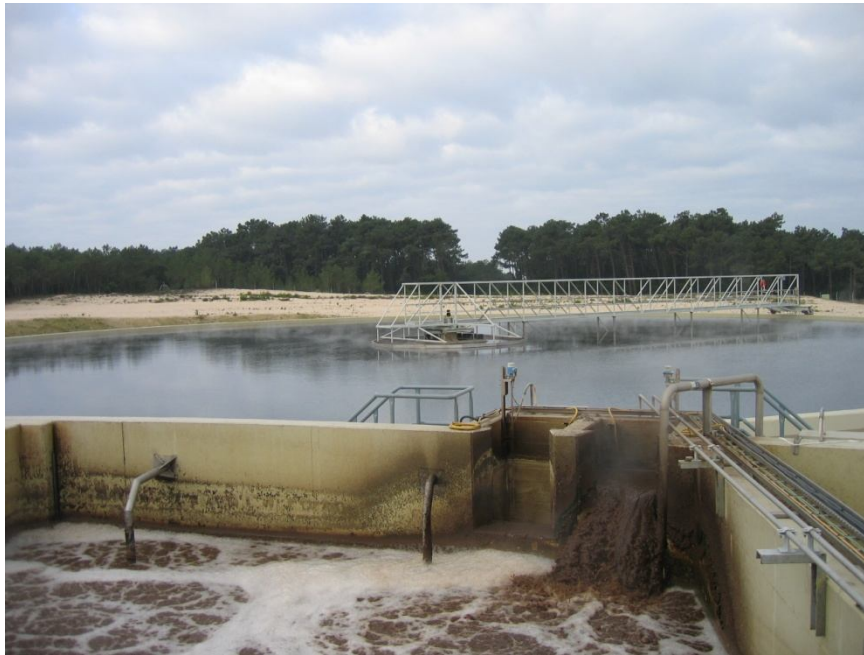
Figura 4.14 - Recirculação de lamas do clarificador para o reator MBP (EP, 2012).
