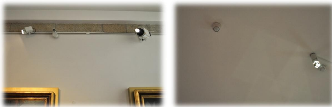
Figura 5.37 - Infraestruturas técnicas no museu do Seminário de Viseu.
