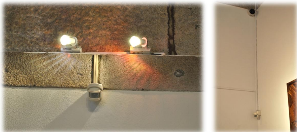
Figura 5.13 - Iluminação e infraestruturas técnicas colocadas no museu de arte sacra e Igreja de S. Lourenço.
