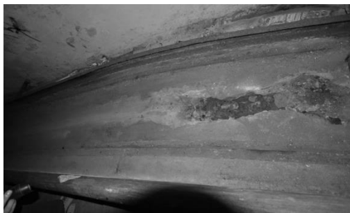
111. Patología pavimento descenso vagoneta
