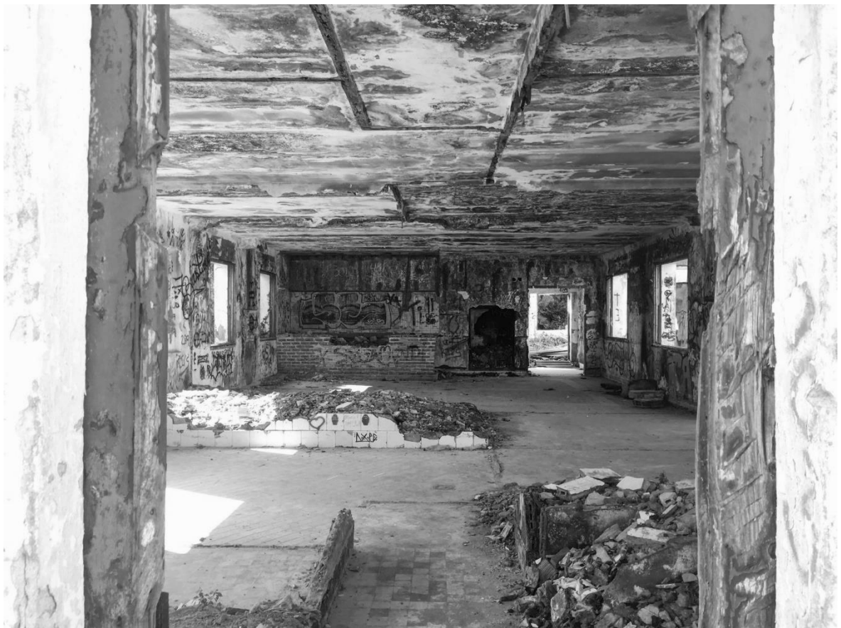
97. Estado de degradación del cuerpo de guardia y cantina
