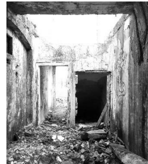
110. Escombros sobre pavimento
