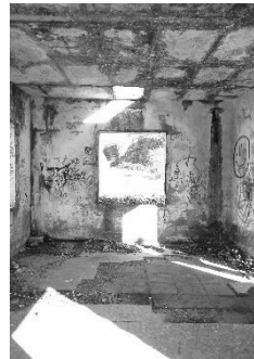
109. Defectos de pavimento
