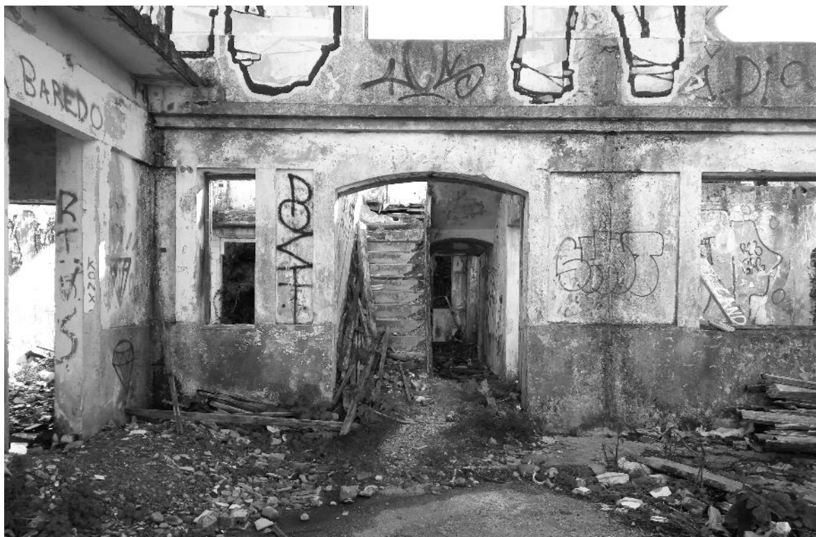
83. Ejemplo de degradación de la Batería J4
