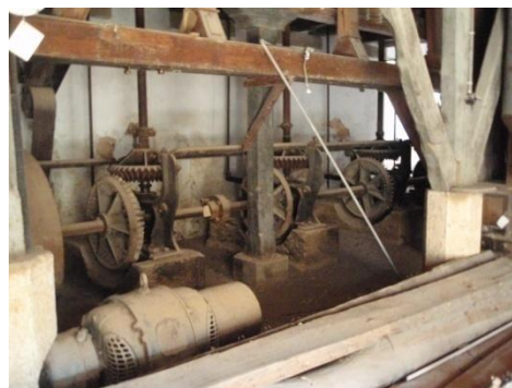
Figura 12 – Conjunto de engrenagens, piso 0; Foto Rita Rosa, 30.Set.2011;
