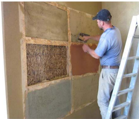
Fig. 271: Acabado interior barro, detalle de barro de Galicia
