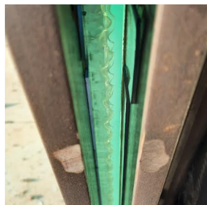
Figura 5.14: Perfil do painel com um dos vidros partidos
