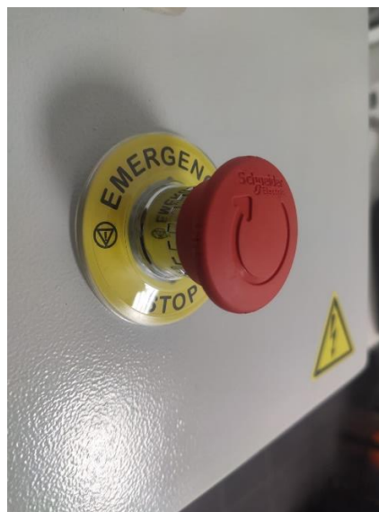
Figura 24 - Botoneira de emergência
