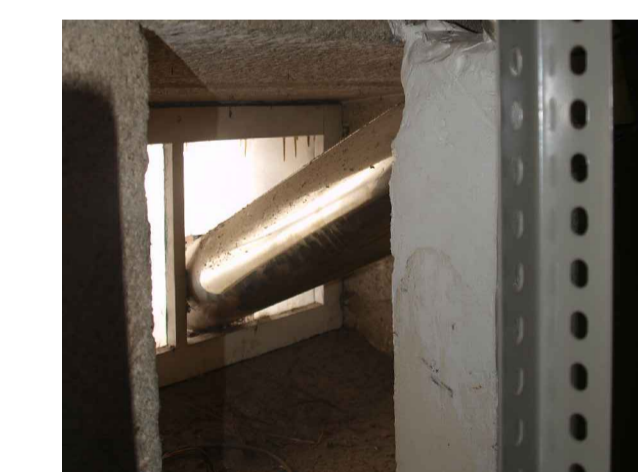
Sistema de ventilación.
