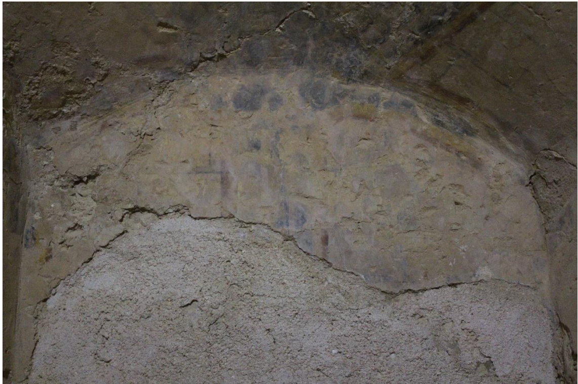
Figura 140. Cimento Portland em contacto com a pintura do topo da escadaria militar da Charola;
