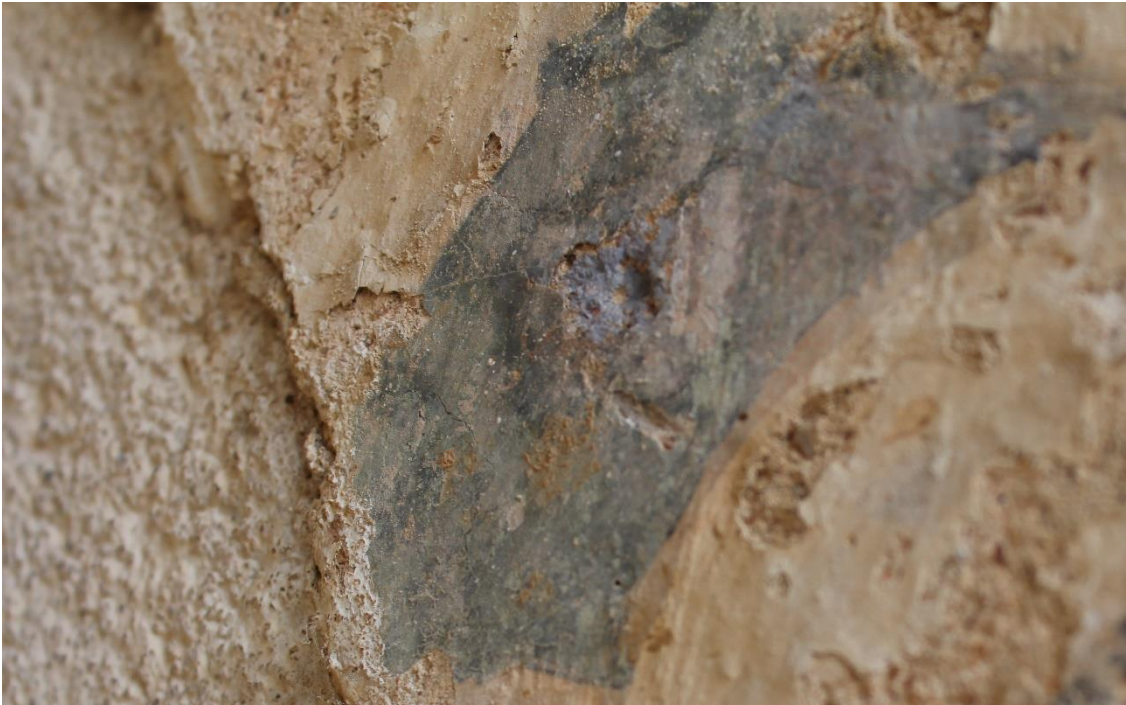
Figura 102. Reintegração cromática mal executada na parede 2a do lado sul do Claustro da Lavagem;
