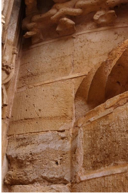
Figura 279. Juntas salientes na parte exterior da Charola;
