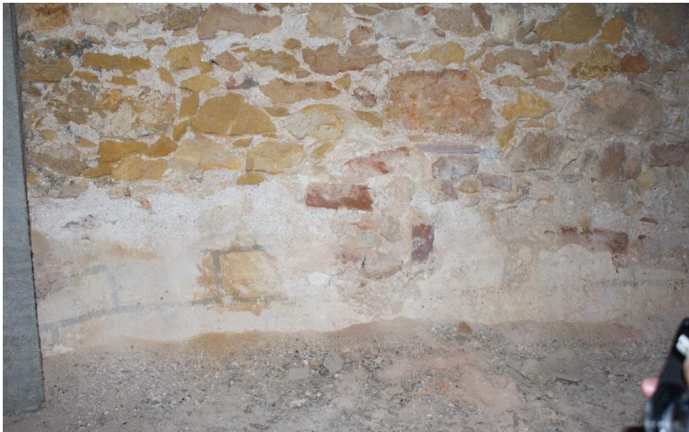
Figura 130. Fragmento de pintura nas paredes do extradorso da Charola a similar cantaria;
