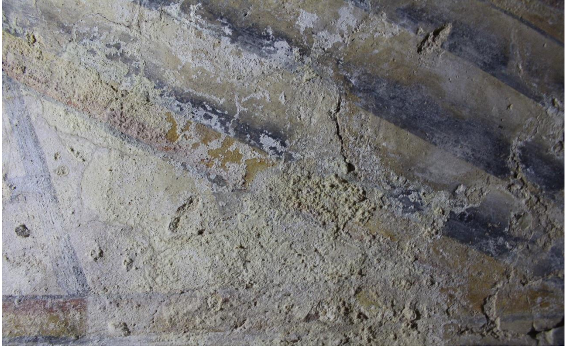
Figura 139. Eflorescência de sais e sujidade na pintura do topo da escadaria militar da Charola;
