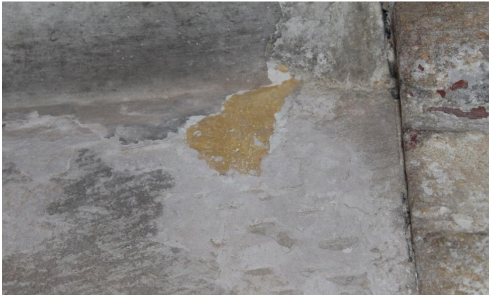
Figura 193. Parte lateral do enxalço da porta do corredor que dá acesso ao Claustro de Santa Bárbara com vestígio de cor ocre;
