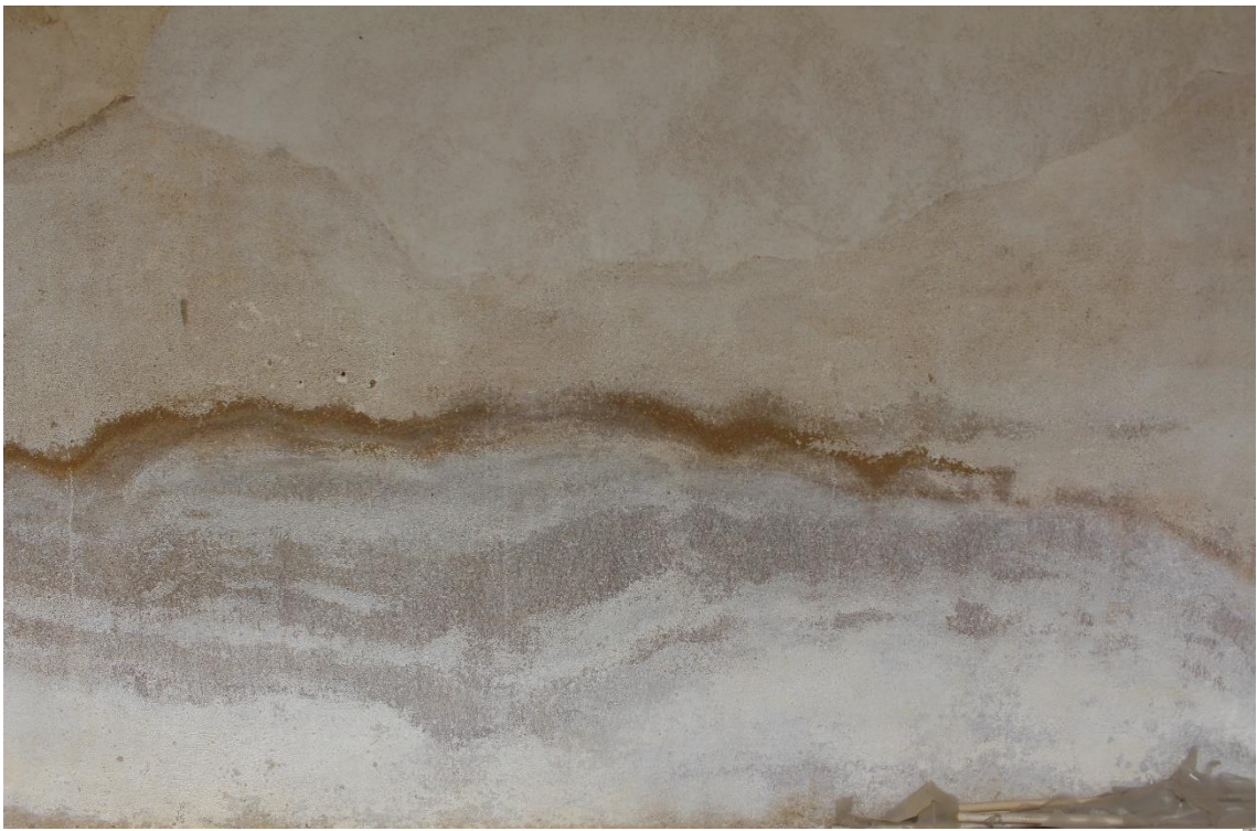
Figura 98. Marcas de ascensão da humidade por capilaridade na zona inferior da parede 2 do lado sul do Claustro da Lavagem;
