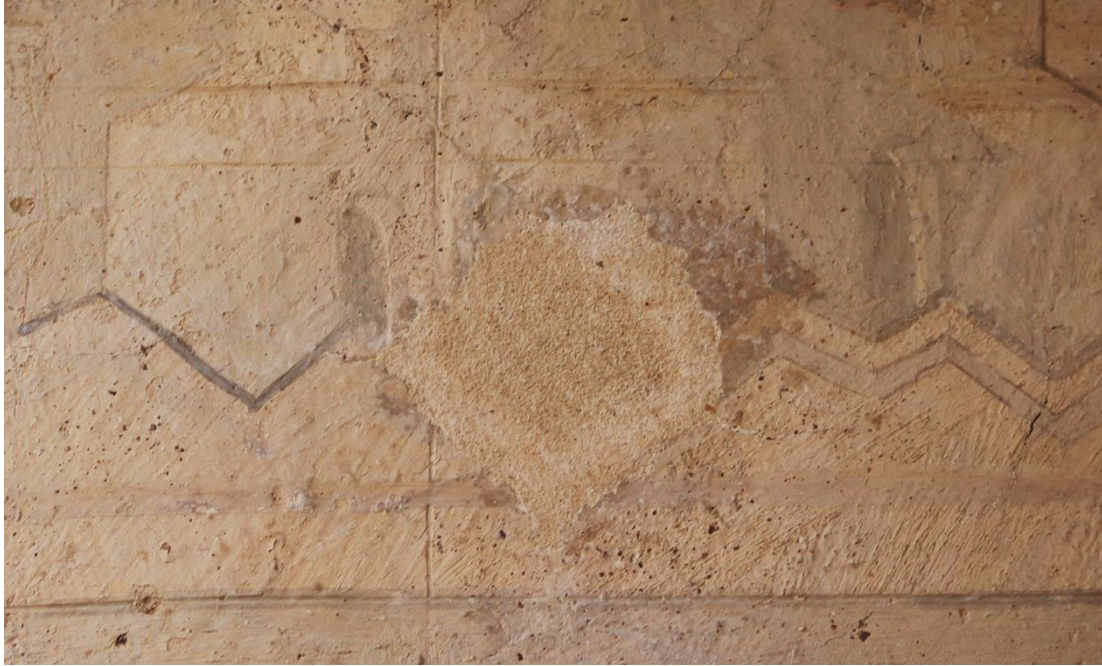
Figura 99. Argamassa de preenchimento com marcas da presença de humidade na parede 1a do lado sul do Claustro da Lavagem;
