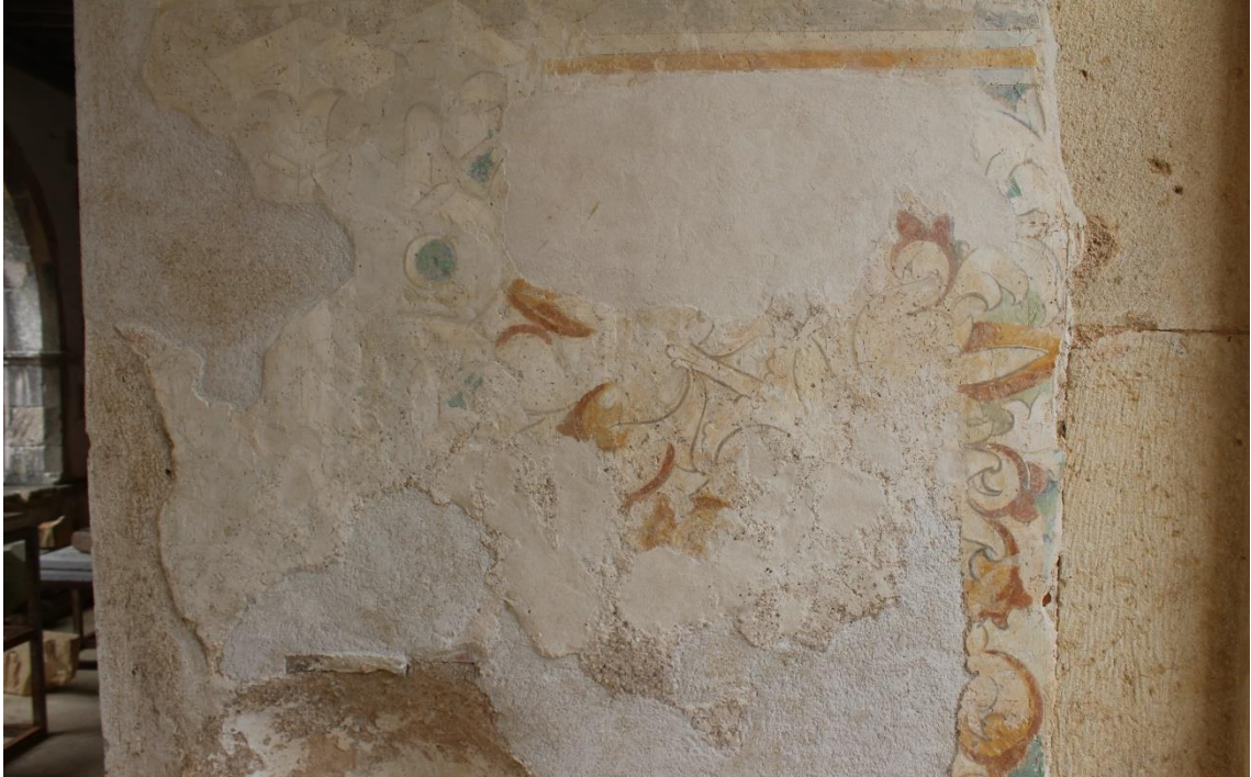
Figura 96. Zona inferior da parede 3a com várias lacunas de grande dimensão, lado sul do Claustro da Lavagem;
