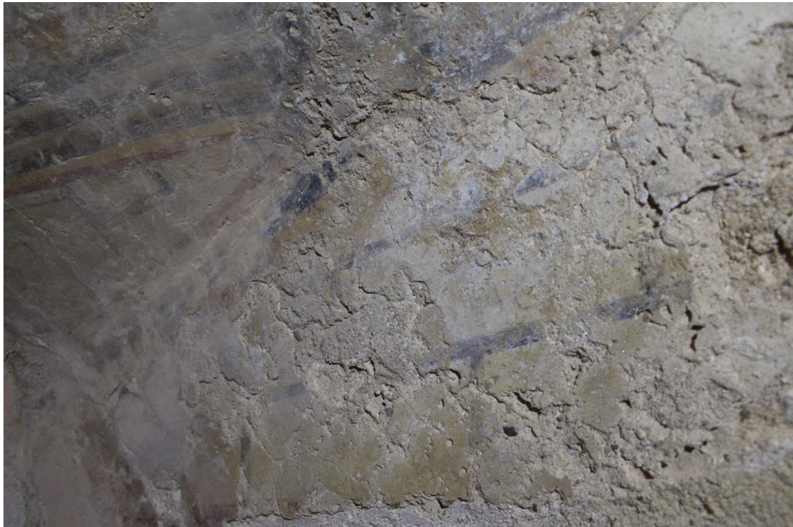
Figura 138. Desagregação do reboco da pintura do topo da escadaria militar da Charola;
