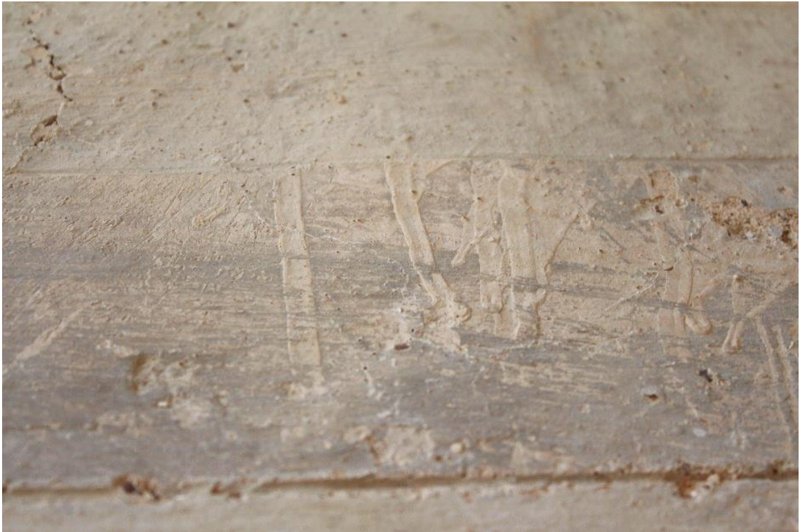
Figura 75. Escorrências de cal na parede 1a, subjacentes à camada cinzenta, lado sul;
