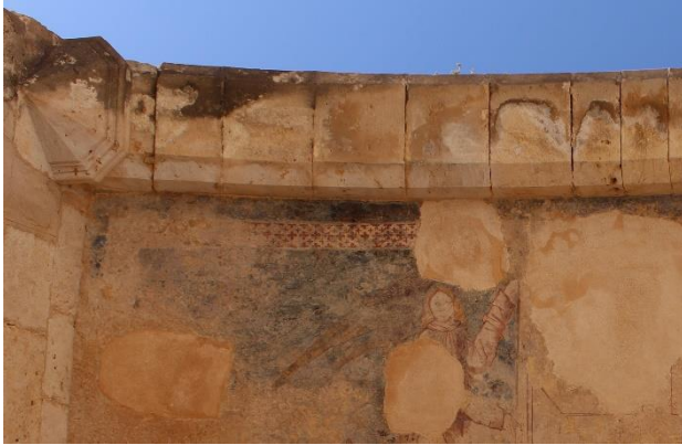
Figura 68. Danos causados no arco adjacente à pintura da antiga entrada da Charola;
