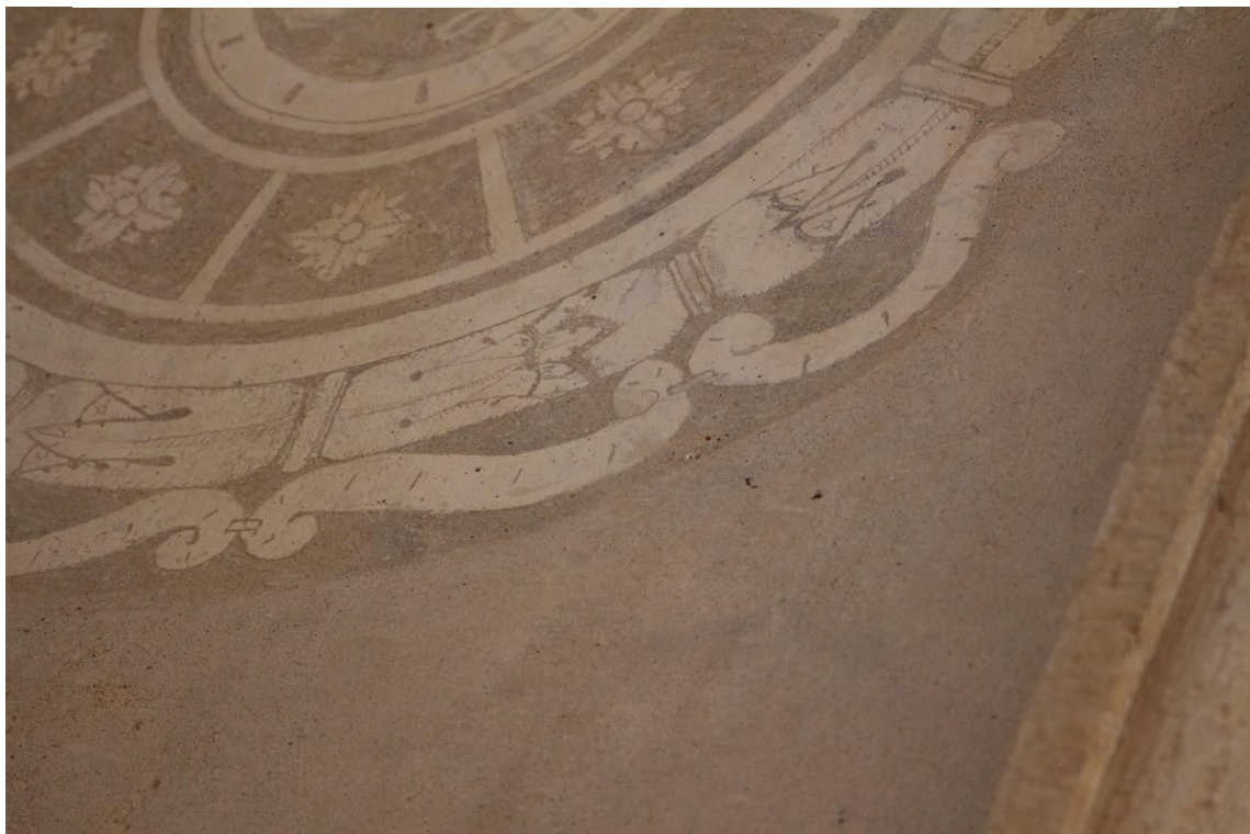
Figura 146. Diferenças de reboco no esgrafito 1;
