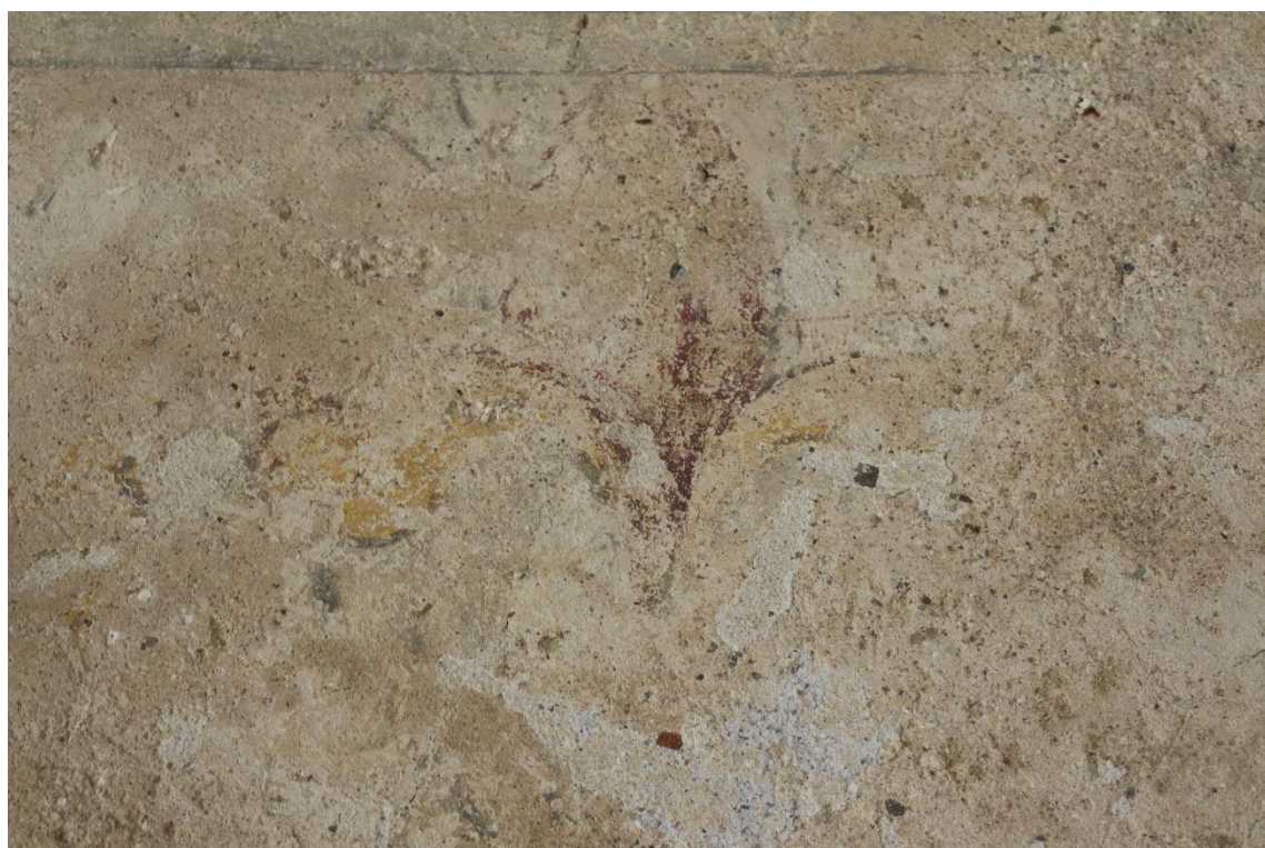
Figura 95. Desgaste acentuado da zona inferior da pintura da parede 1 do lado sul do Claustro da Lavagem;
