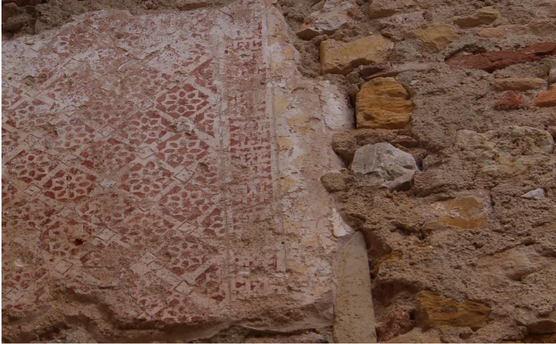
Figura 107. Alvenaria a uma cota mais alta do que a pintura da Sala do Paço;
