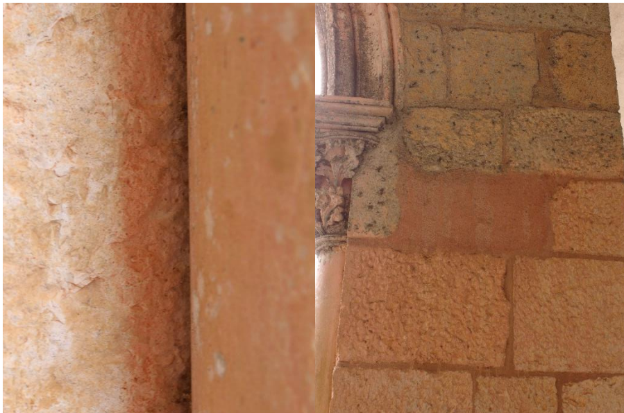
Figura 195. Tingimento de vermelho em zonas mais escondidas e interiores das paredes do Claustro do Cemitério;
