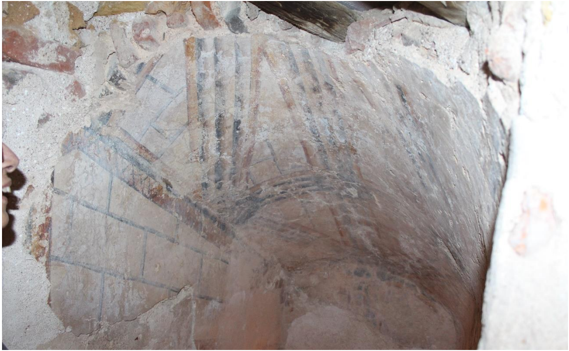
Figura 133. Vista geral dos vestígios de pintura mural do topo de abóboda da escadaria militar;
