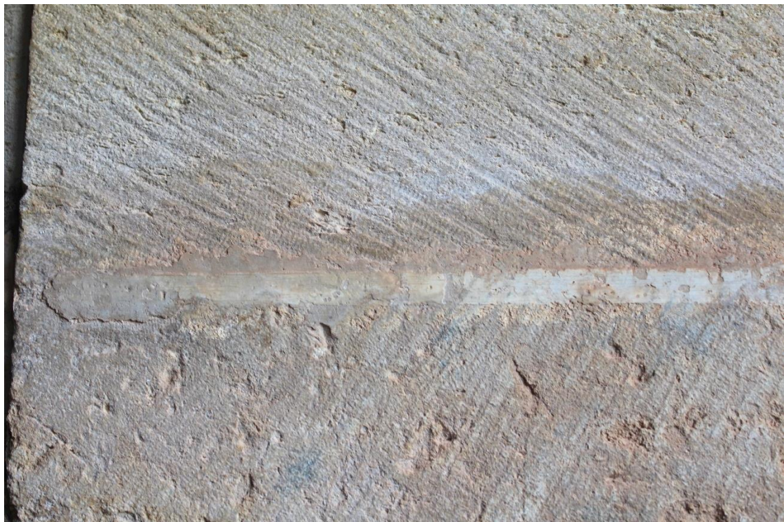
Figura 282. Junta pintada no enxalço de um dos janelões sul do Dormitório;
