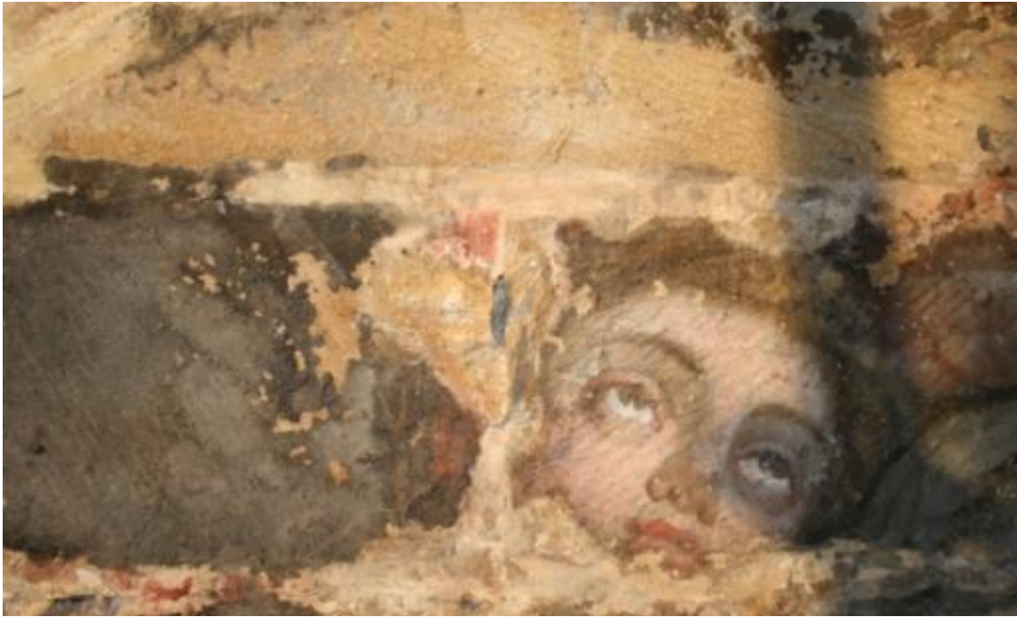
Figura 281. Juntas salientes subjacentes à pintura mural do arco triunfal da Charola;
