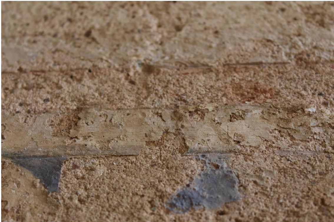
Figura 100. Destacamento da camada de cal com inertes da parede 2a do lado sul do Claustro da Lavagem;
