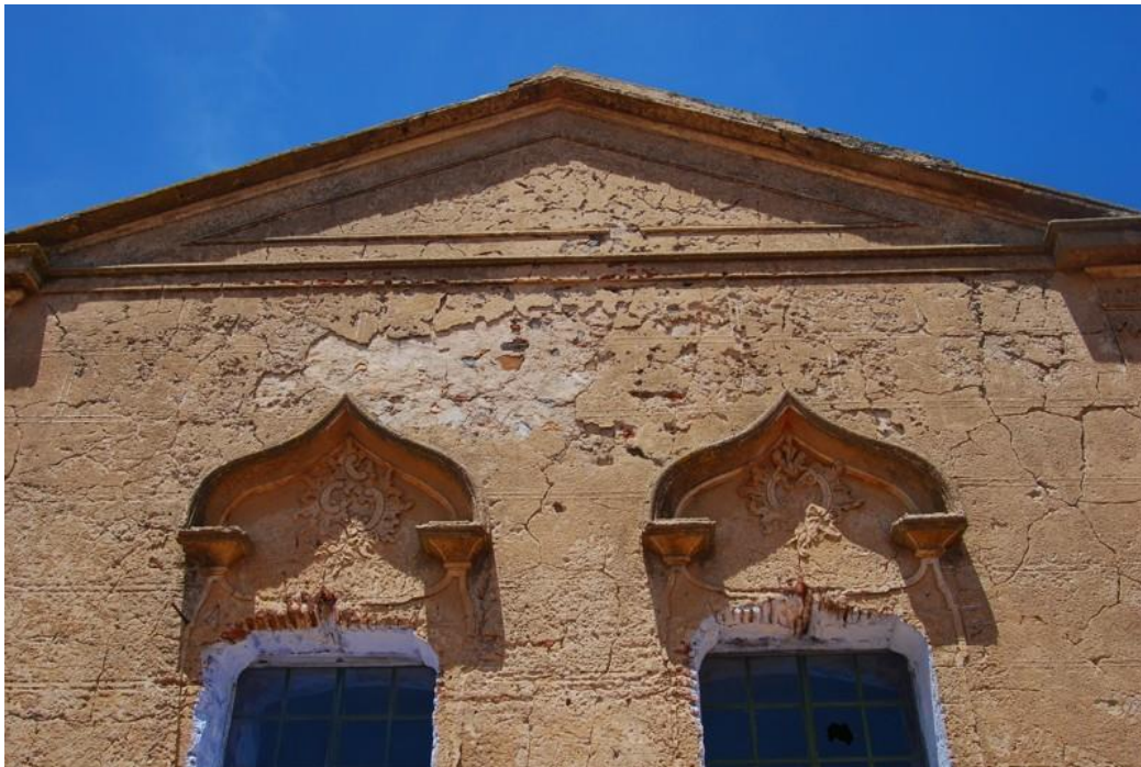
Figura 289. Casa dentro das muralhas do Castelo de Ouguela, com revestimento de imitação de canataria, com juntas duplas. Autoria: Sofia Salema;
