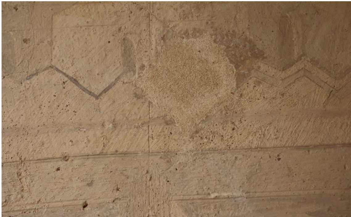
Figura 83. Marcas das cerdas do pincel que aplicou a cal com inertes na parede 1a do sul
