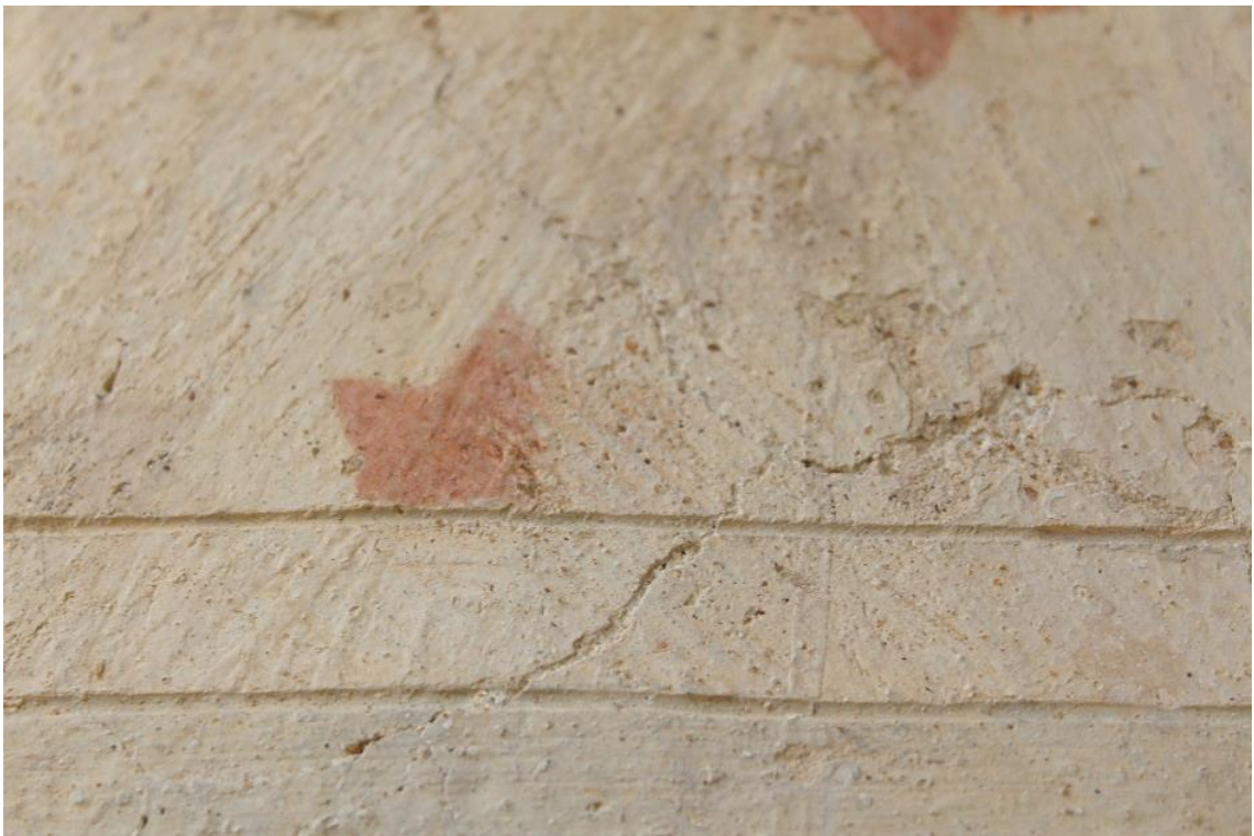
Figura 76. Escorrências de cal na parede 1a, atravessada pelas incisões da parede 1a do lado sul;
