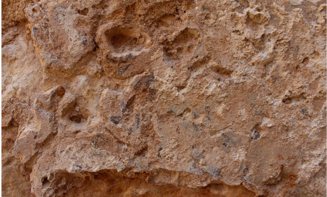
Figura 119. Pormenor de reboco com vestígios negros que parecem ser similares aos raios das estrelas mudéjares, zona norte do piso térreo do Paço;
