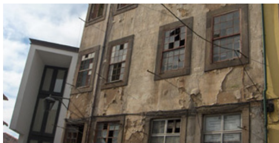
Fig. 1 - Edifício em ruínas - Rua de D. Hugo
