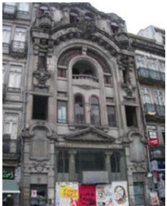
Fig. 2 - Edifício em ruínas - Avenida da Ponte
