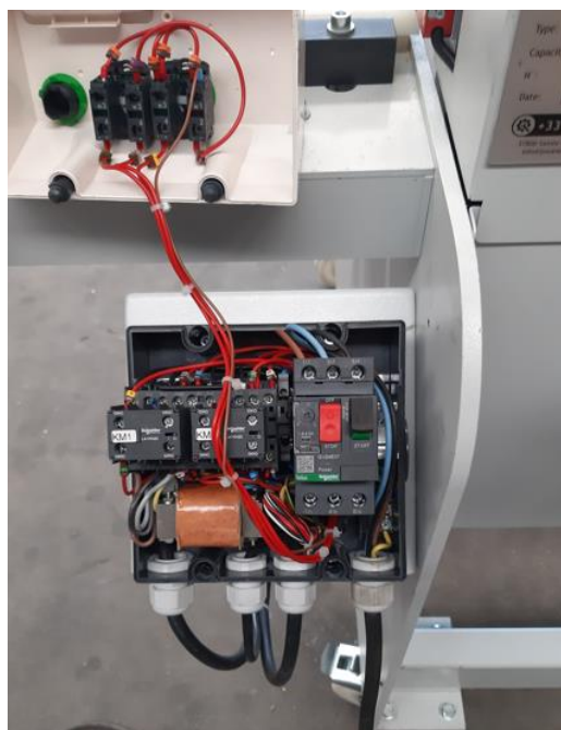
Figura 56 – Ligação elétrica da perfiladora de Boudin
