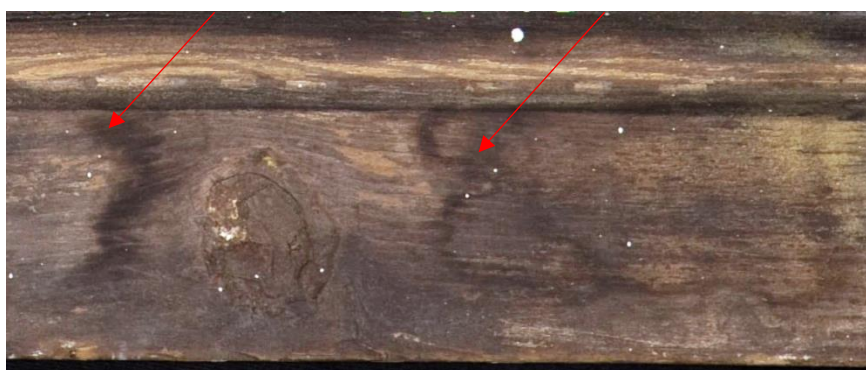
Fig. 78 - Manchas de humidade da madeira na tábuia inferior da moldura | A.P.
