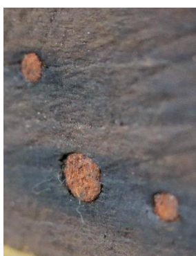
Fig. 77 - Corrosão dos acessórios metálicos ferrosos da moldura | A.P.
