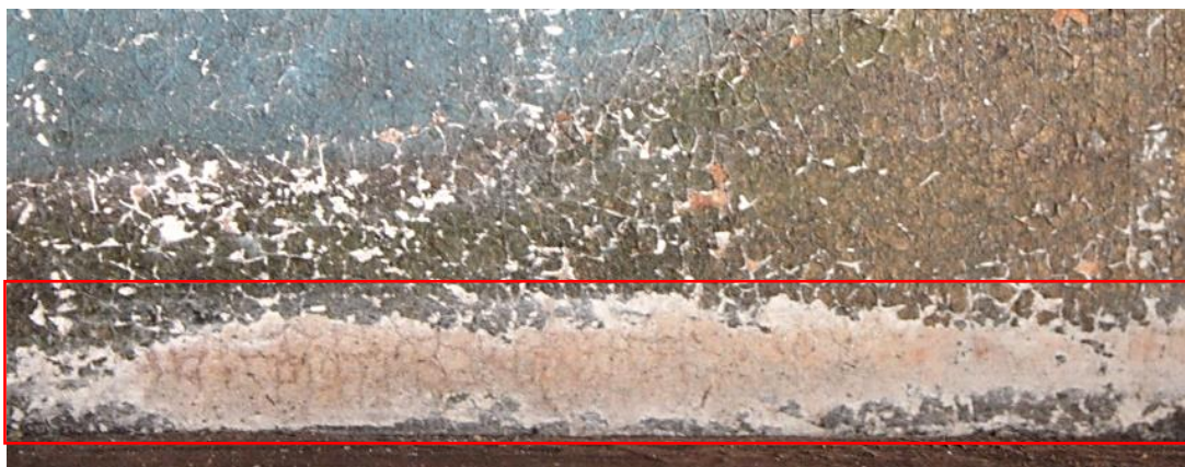
Fig. 63 - Abrasão pontual com perda de material ao nível da camada de preparação | A.P.
