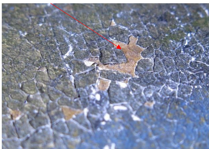
Fig. 64 - Lacunas ao nível da camada de preparação | Fotografia através de lupa de mão com iluminação (2,5 x de ampliação) | A.P.
