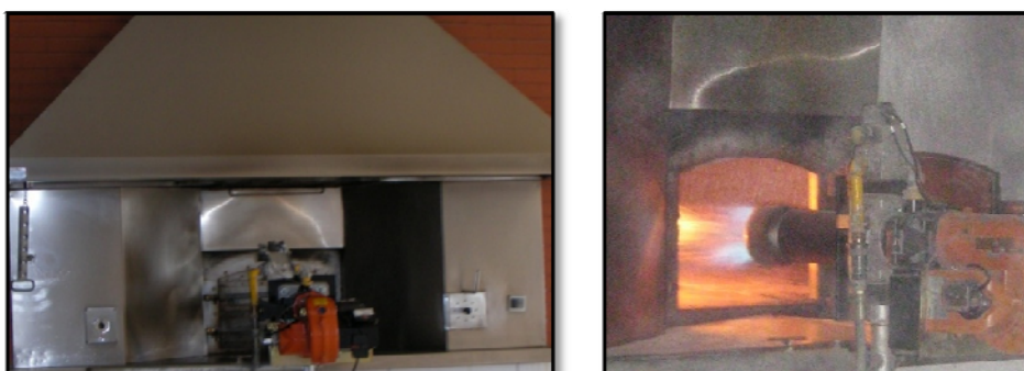
Figura 29:Forno de alvenaria com aquecimento direto (Fonte: Raquel Breyd).
