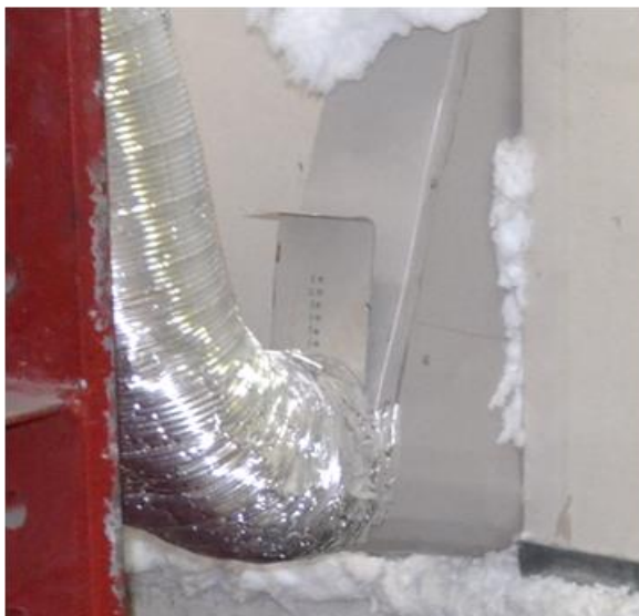
Fig. 79 – Difusor com registo para afinação de caudal.
