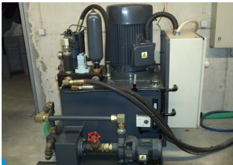
Fig. 10 - Unidade hidráulica utilizada nos ensaios.
