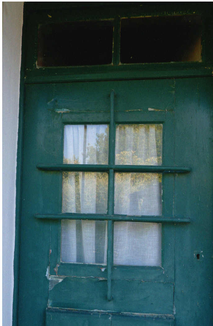
Fig.15 e 16 Desgaste notório nas portas e janelas da Casa de Paredes.
