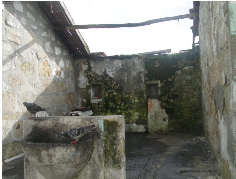
Fig. | 112 | Vista desde el interior de la fachada posterior de una vivienda de PB, ahora en ruinas.
