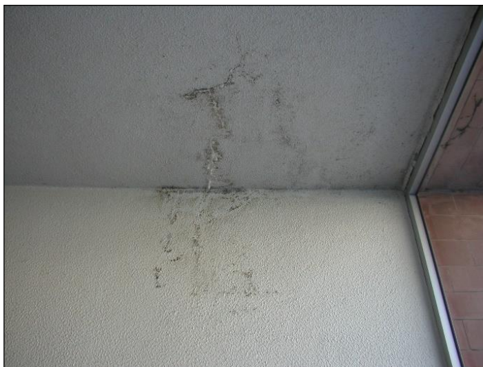
Figura 75 - Infiltrações em paredes de zonas comuns (Fonte: Autor)
