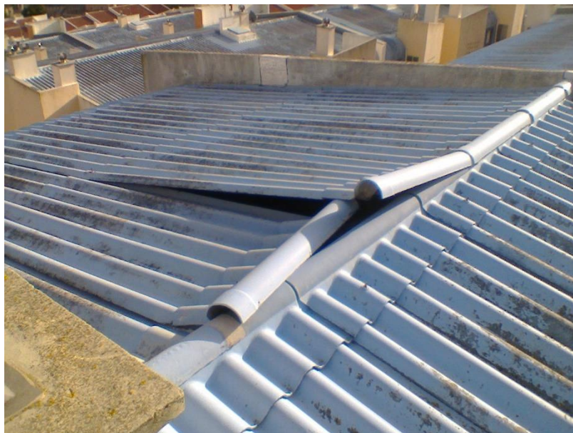
Figura 78 – Elementos de revestimento de cobertura deteriorados (Fonte: Autor)
