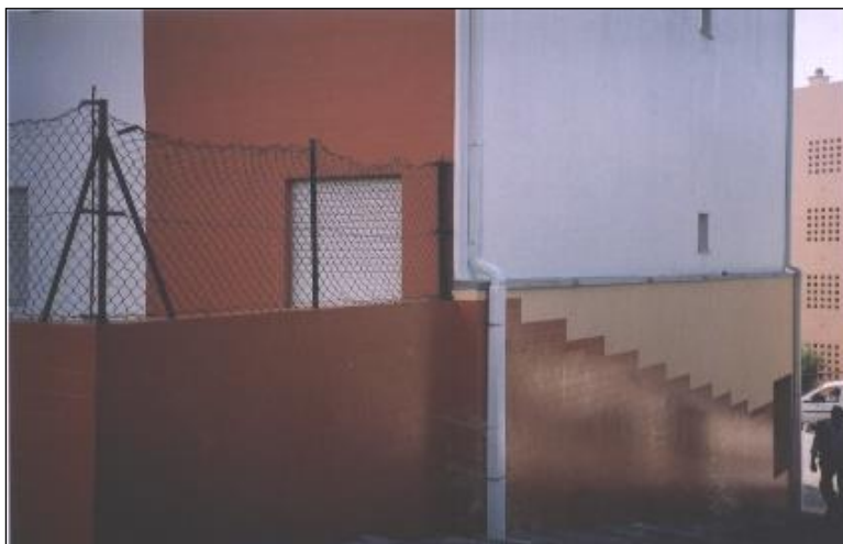
Figura 92 - Tubo de queda novo (Fonte: Autor)
