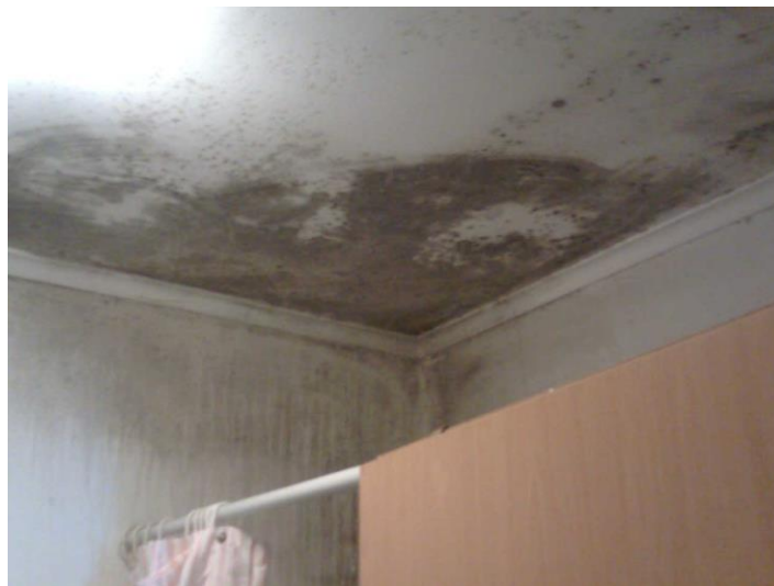
Figura 48 – Manchas de bolores (Fonte: Autor)
