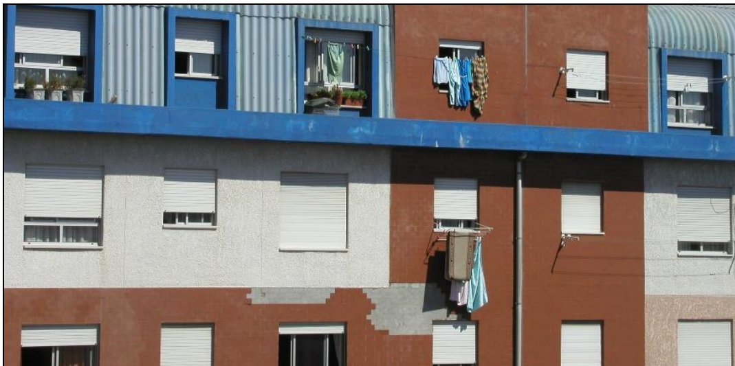
Figura 66 - Deficiente aderência dos ladrilhos (Fonte: Autor)
