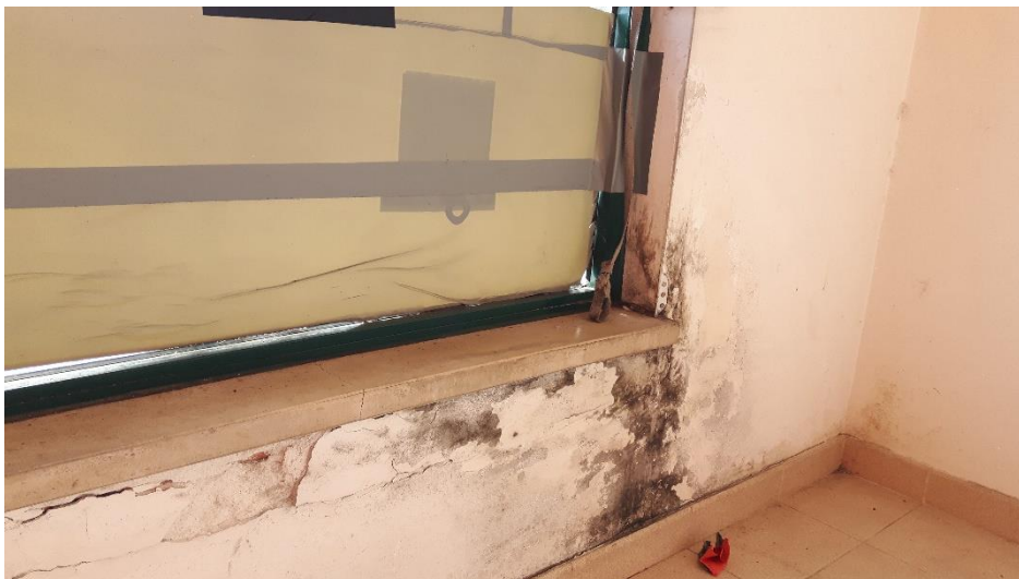
Figura 45 – Humidades devido a infiltração pelo peitoril (Fonte: Autor)
