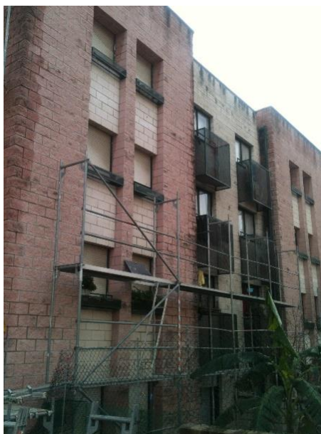
Figura 34 – Humidades em paredes exteriores (Fonte: Autor)
