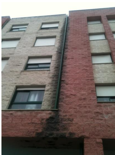
Figura 28 – Humidade devido a desembocadura do tubo de queda (Fonte: Autor)
