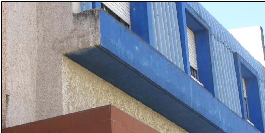
Figura 62 - Fachada com pintura deteriorada (rebocos e lixiviação) (Fonte: Autor)
