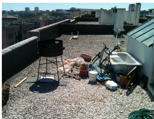
Figura 33 – Cobertura sujeita a mau uso e falta de manutenção (Fonte: Autor)
