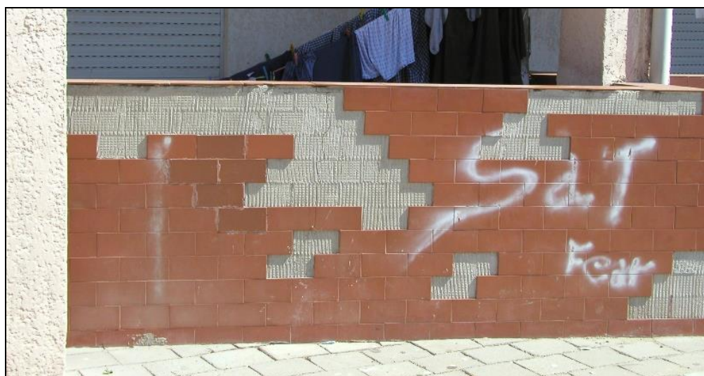
Figura 67 - Deficiente aderência dos ladrilhos devido à lixiviação da base (Fonte: Autor)
