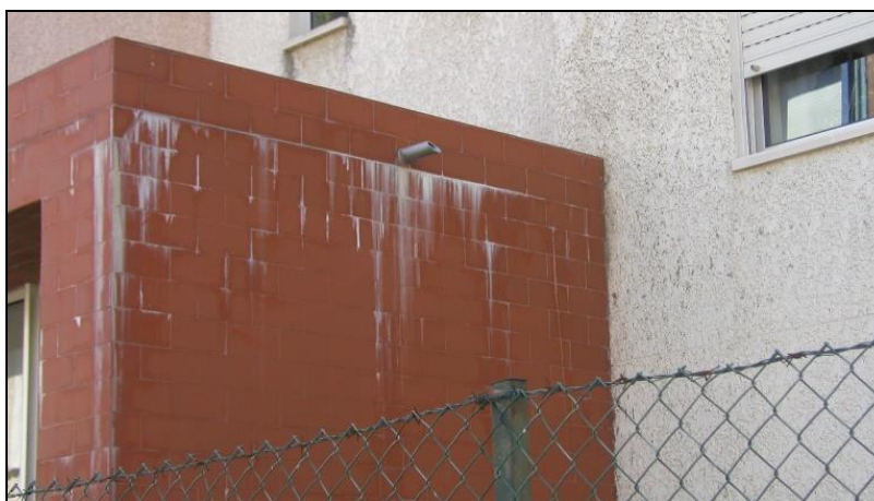
Figura 69 - Lixiviação ao nível da laje de cobertura de entrada do edifício (Fonte: Autor)
