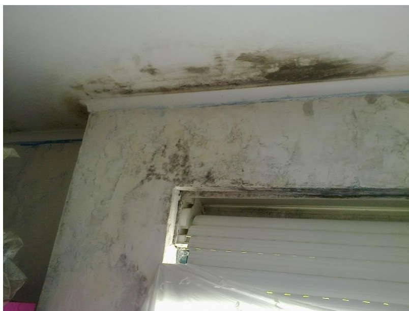
Figura 44 – Infiltração de águas da chuva (Fonte: Autor)
