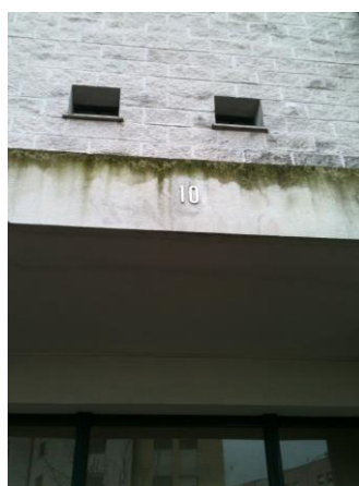
Figura 36 - Escorrência na parede exterior (Fonte: Autor)
