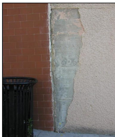
Figura 63 - Reboco degradado (Fonte: Autor)
