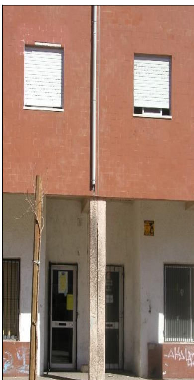
Figura 59 - Tubo de queda deteriorado (Fonte: Autor)
