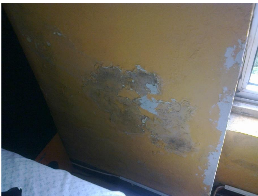
Figura 74 – Humidades de precipitação em paredes interiores (Fonte: Autor)
