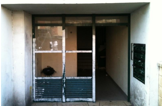
Figura 42 – Caixilharia exterior vandalizada (Fonte: Autor)
