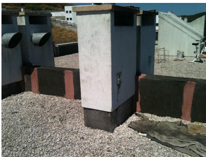
Figura 31 – Fissuração em chaminés (Fonte: Autor)
