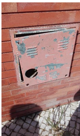
Figura 70 - Oxidação de elemento metálico (Fonte: Autor)
