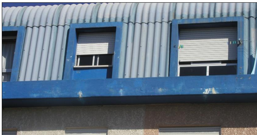
Figura 61 - Pintura degradada com corrosão das armaduras e lixiviação do betão (Fonte: Autor)
