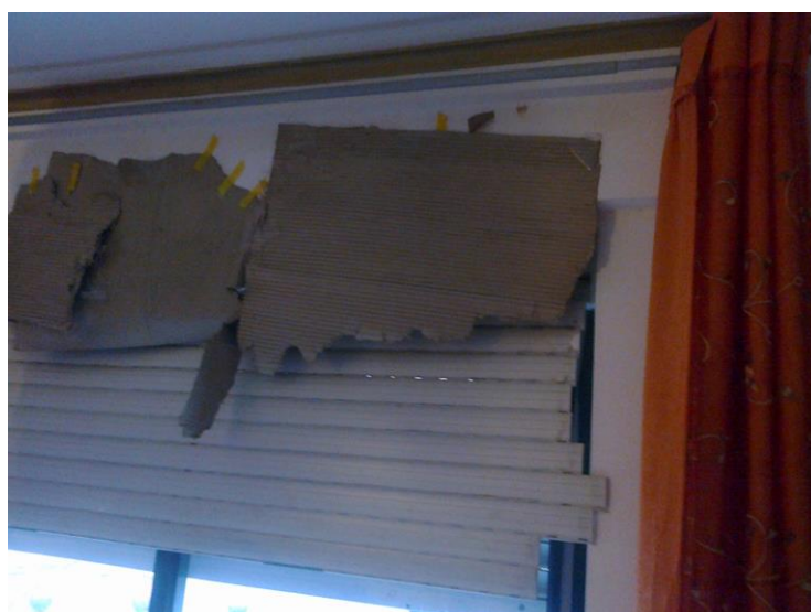
Figura 53 – Estores e caixa de estores vandalizados (Fonte: Autor)
