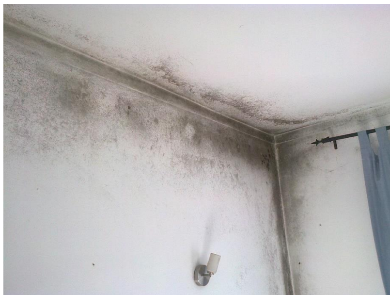
Figura 73 - Humidades de condensação devido a pontes térmicas (Fonte: Autor)
