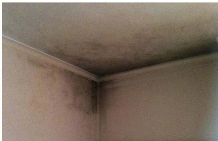
Figura 49 - Humidades de condensação devido a pontes térmicas (Fonte: Autor)
