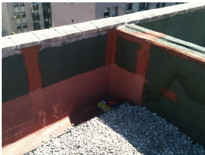
Figura 24 – Caleira com pendente insuficiente (Fonte: Autor)
