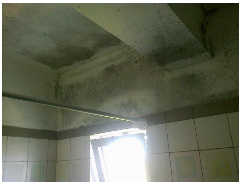
Figura 72 - Fungos em tetos de IS junto à empena (Fonte: Autor)
