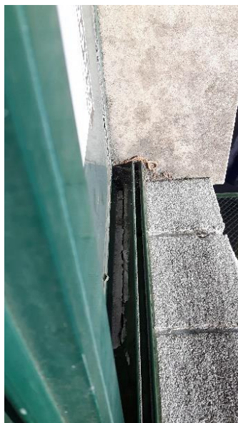
Figura 40 - Degradação do mástique da caixilharia em alumínio lacado (Fonte: Autor)
