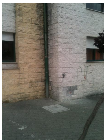
Figura 38 – Juntas de “Split” deterioradas (Fonte: Autor)
