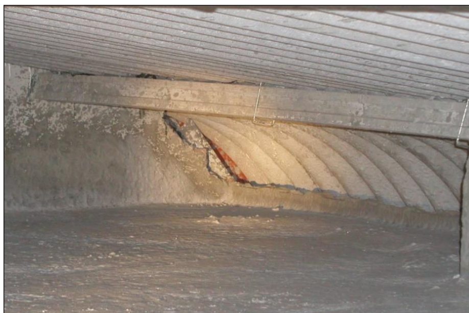
Figura 77 – Isolamento térmico da cobertura humedecido (Fonte: Autor)
