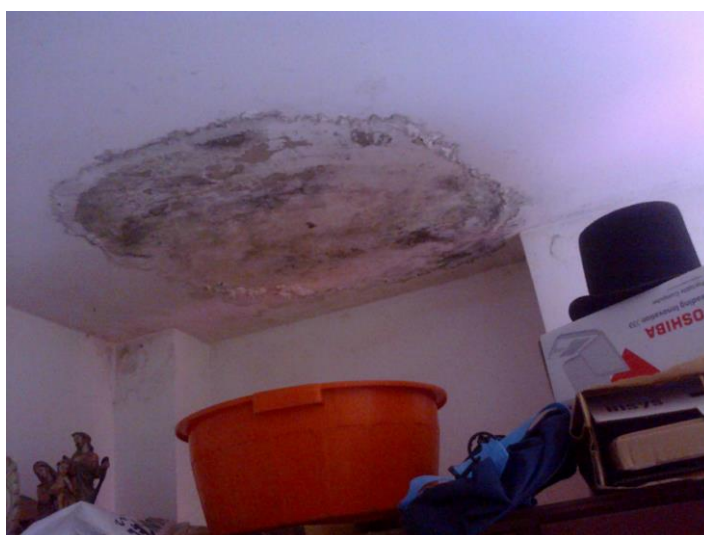
Figura 25 – Infiltração proveniente da cobertura (Fonte: Autor)
