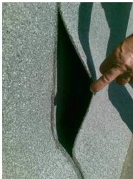
Figura 23 - Tela de impermeabilização descolada (Fonte: Autor)
