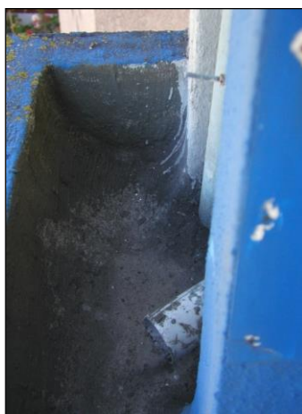
Figura 56 - Solução improvisada de caleira (Fonte: Autor)
