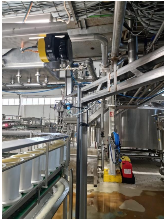
Figura 83 – Componentes instalados no contexto fabril.
