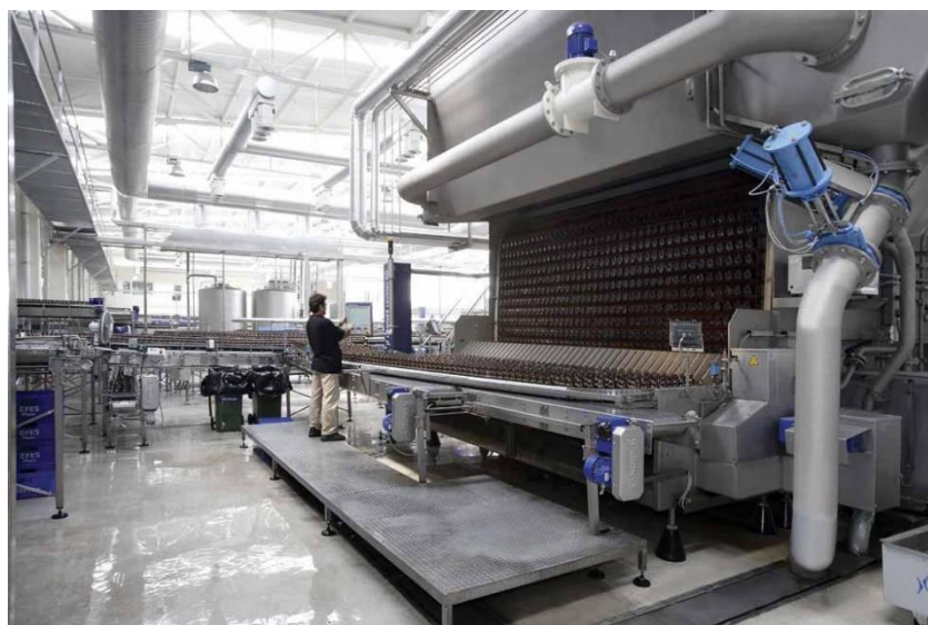
Figura 8 – Lavadora de garrafas de marca Krones [9].
