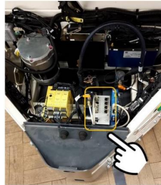
Figura 13 - Portas Ethernet para a comunicação com o AGV
