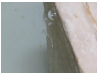
Figura 240 Bolhas de ar proveniente de fissura interior
