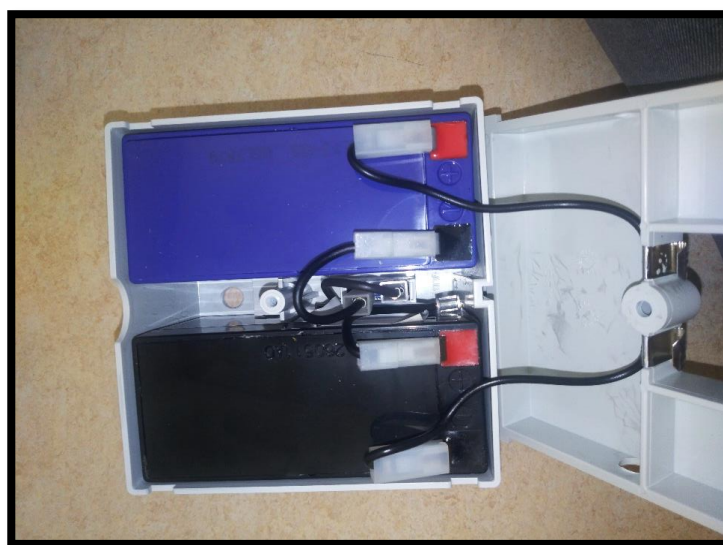
Figura 61: Módulo das baterias aberto. À esquerda encontra-se a bateria substituída e à direita a bateria obsoleta. Também no lado direito encontra-se localizado o fusível de térmico. É necessário, durante a troca das baterias, respeitar as respetivas ligações elétricas de modo a evitar curto-circuitos e danificação do material.
