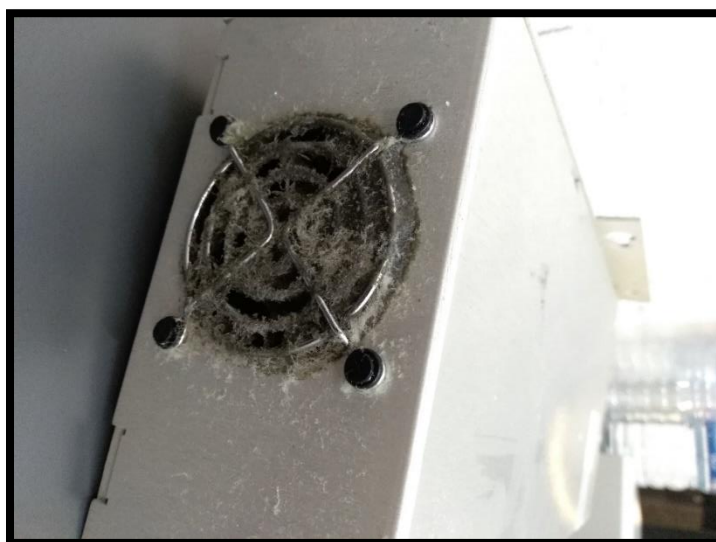
Figura 79: Componente completamente obstruído provocando o seu sobreaquecimento e posterior danificação.
