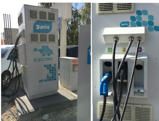
Figura 6.1. Posto de carregamento de VE da Prio.
